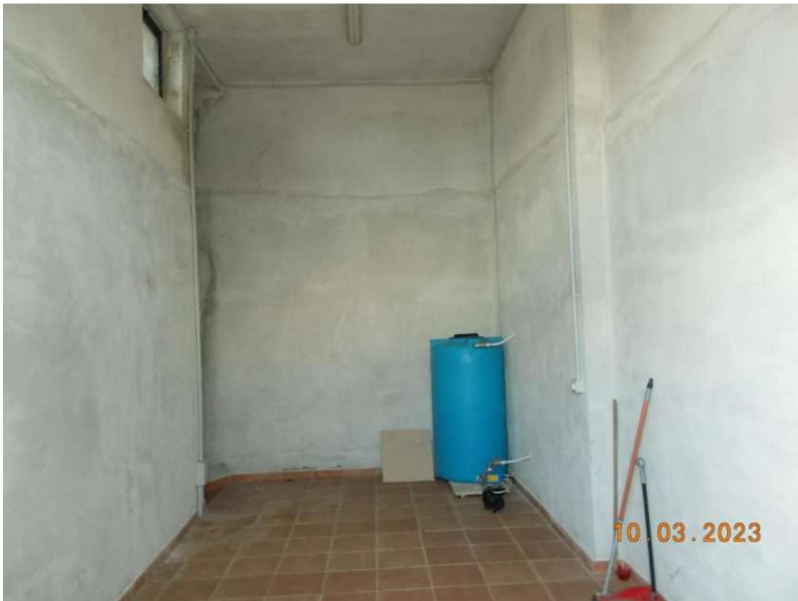
Foto 13 e 14 – Deposito e locale tecnico ascensore al piano S2 - Fg 4 p.la 297 sub 13
