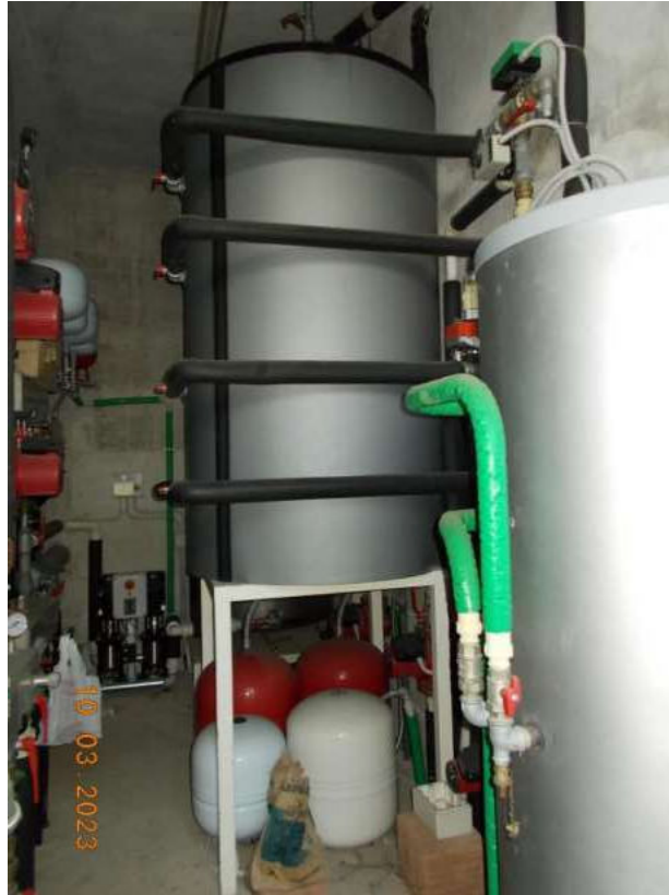
Foto 11 e 12 - Centrale idrica e termica al piano S2 – Fg 4 p.IIa 297 sub 12
