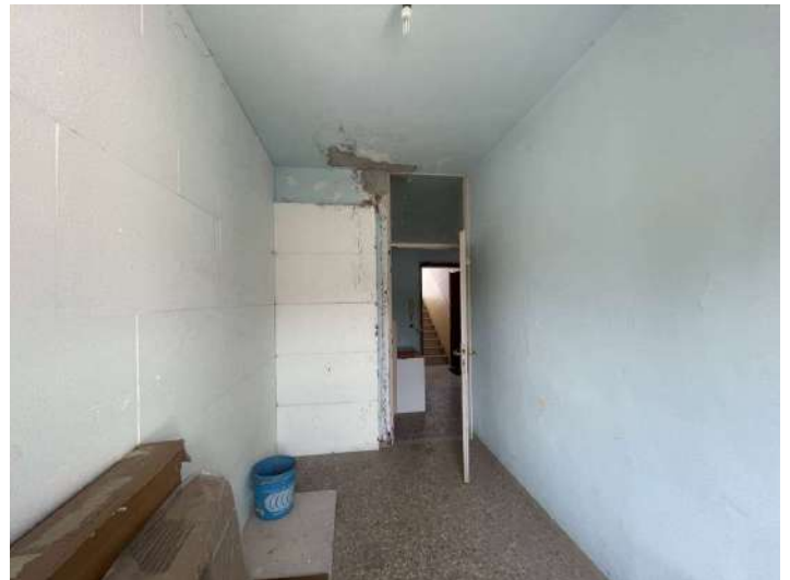
foto n. 12 – ripostiglio: pannelli isolanti
