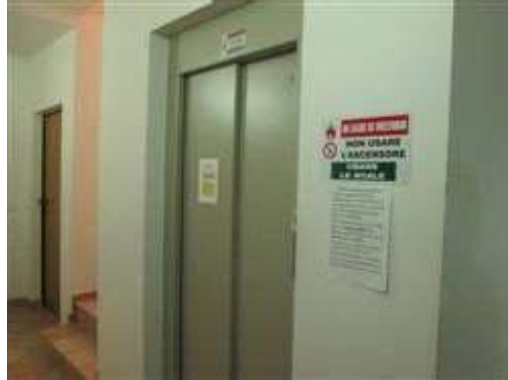
Ascensore interno condominiale - Fabbricato Cagli
