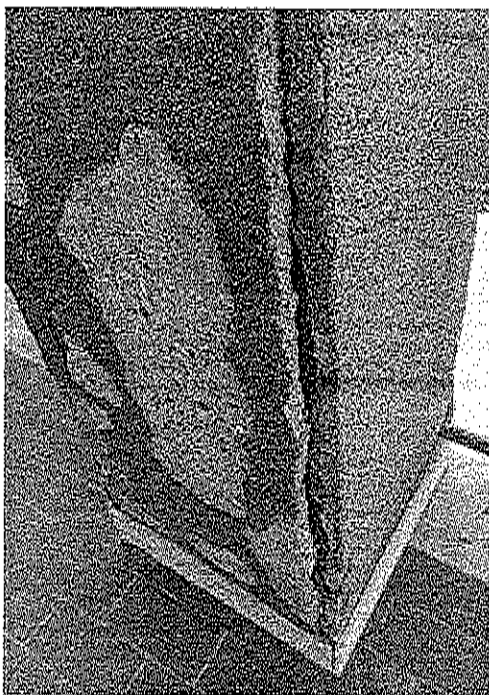
Intonaco di rivestimento pilastro porticato
