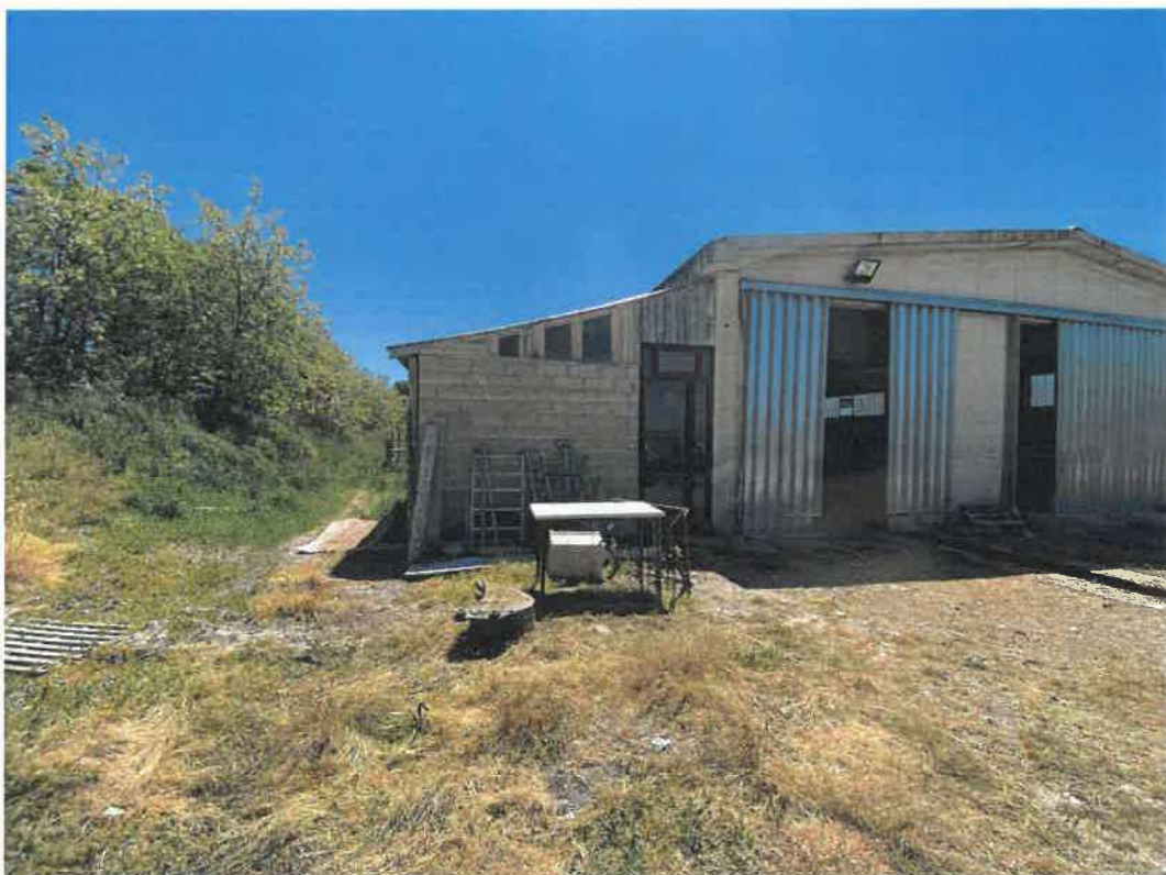
Foto 06 – stalla per ricovero animali e porzione abusiva da demolire (f.134, mapp.124)
