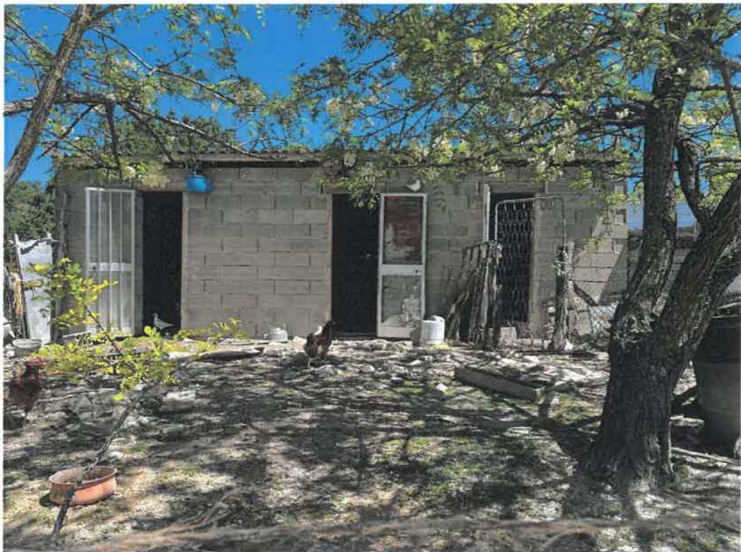
Foto 08 – stalla (pollaio) abusiva da demolire (f.134, mapp.193)
