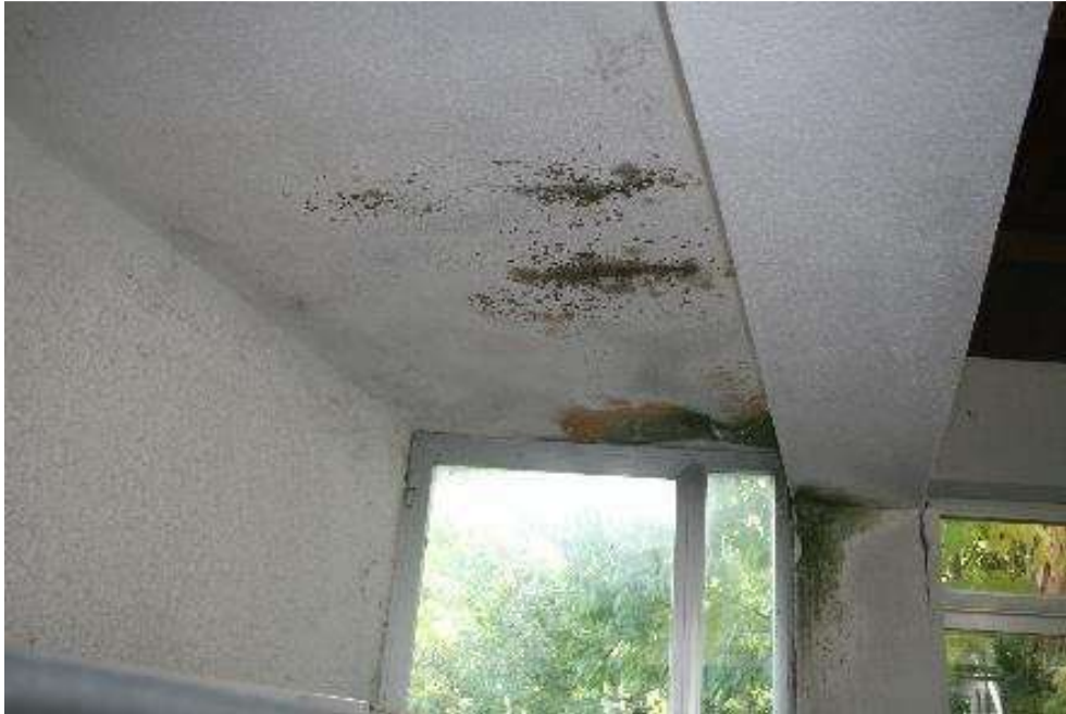
Foto n. 133: veranda - degradi presenti nel soffitto e in corrispondenza di travi/pilastri
