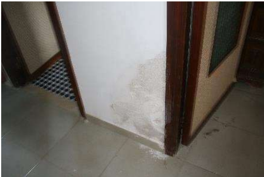
Foto n. 110: degradi presenti nel corridoio p.t.
