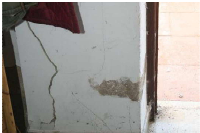
Foto n. 108: degradi presenti all'ingresso del salone
