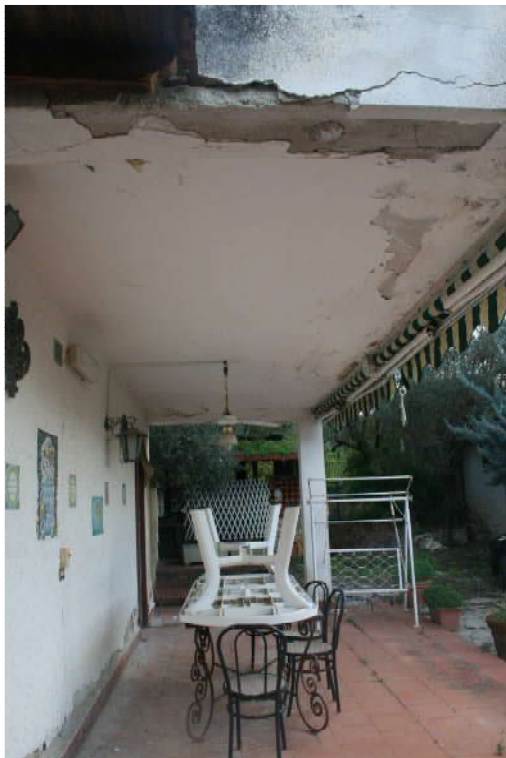
Foto n. 107: degradi presenti nel portico
