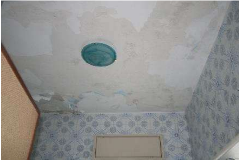
Foto n. 109: degradi presenti nel soffitto del wcb
