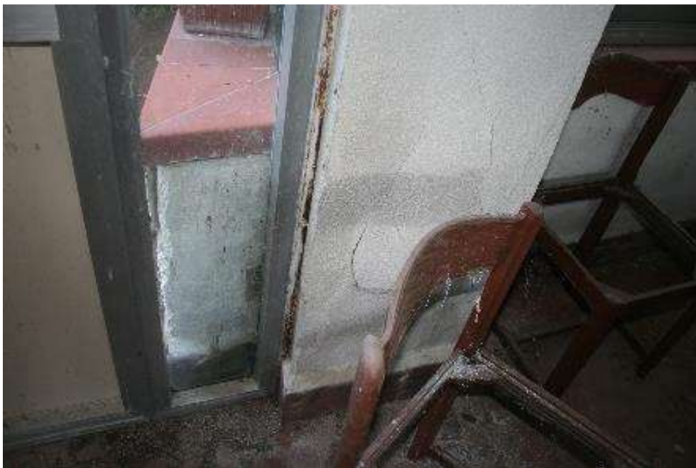
Foto n. 134: veranda – degradi presenti nelle murature per umidità da risalita
