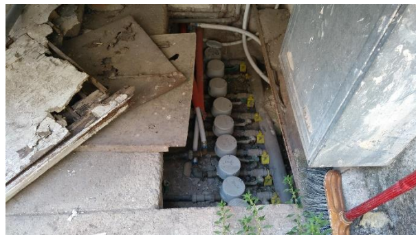
Contatore impianto idrico (ubicazione: esterno fabbricato)
