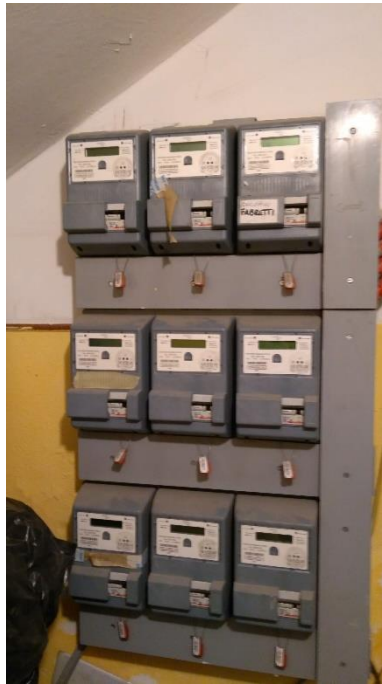
Contatore impianto elettrico (ubicazione: disimpegno vani cantina)
