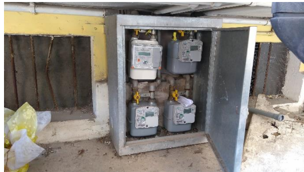
Contatore impianto gas (ubicazione: esterno fabbricato)
