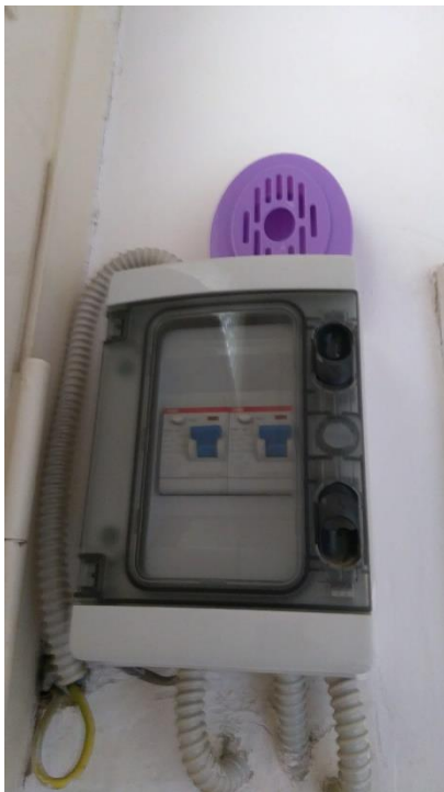
Quadro elettrico interno
