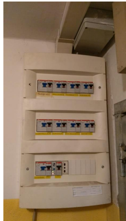
Quadro elettrico generale (ubicazione: disimpegno vani cantina)
