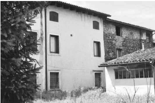
foto 5 - vista da nord est del prospetto nord sul retro dell'abitazione (centro foto) in località Le Ché, con la parete esterna sottogronda del piano secondo – zona notte con tetto in falda – con vistosa igrofanie per percolazione all'imposta della falda per l'inadeguato presidio della grondaia e copertura
