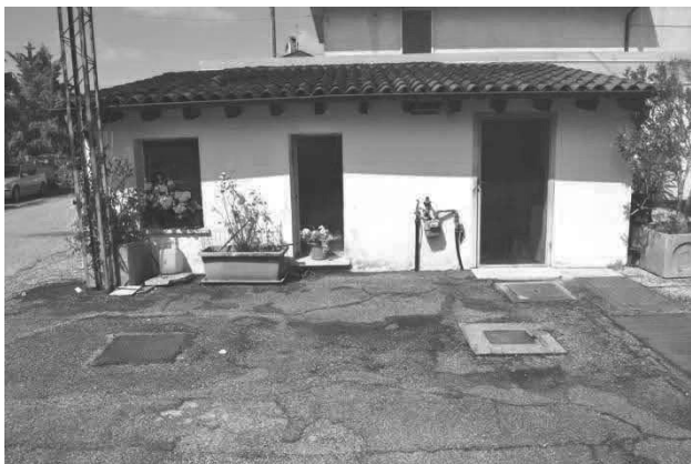
foto 3 - scorcio del prospetto est del deposito/c.t. m.n. 684 costituito da un ex fabbricato rurale d'epoca allibrato per la sola parte sud (sinistra nella foto) in quanto la parte nord – con porta d'ingresso e caldaia murale dell'abitazione staggita risulta ridossata a fabbrica di terzi (destra nella foto) con la corte comune m.n. 82 in primo piano
