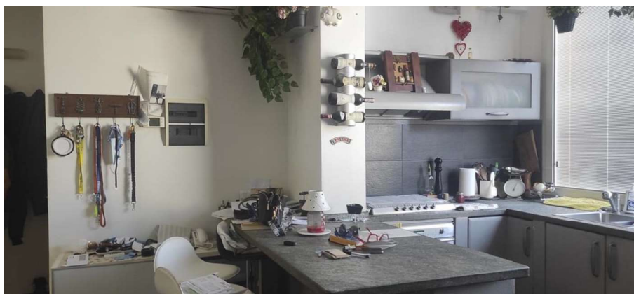
Figura 13: Interno 1 – Angolo cottura difforme dallo stato legittimato
