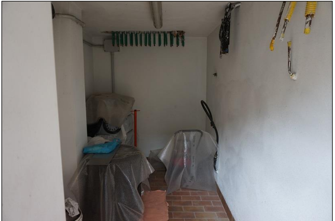
FOTO 13 – Piano interrato – Centrale termica
