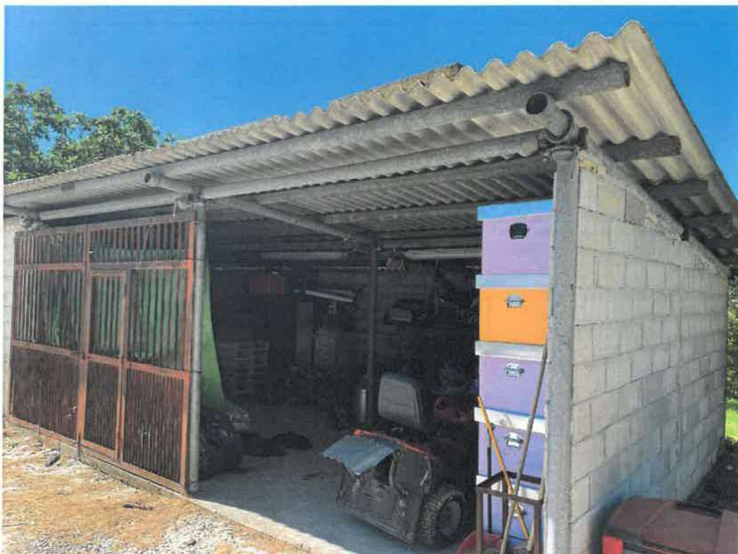
Foto 01 – tettoia abusiva da demolire (f.134, mapp.191)
