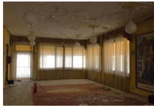
Vista di una porzione della sala ristorante in cui si evidenziano diffuse esfoliazioni dello strato corticale interno dell'intradosso del solaio superiore.
