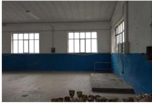
Presenza fotografica interna che descrive la presenza dell'impianto elettrico privo della dichiarazione di conformità.
