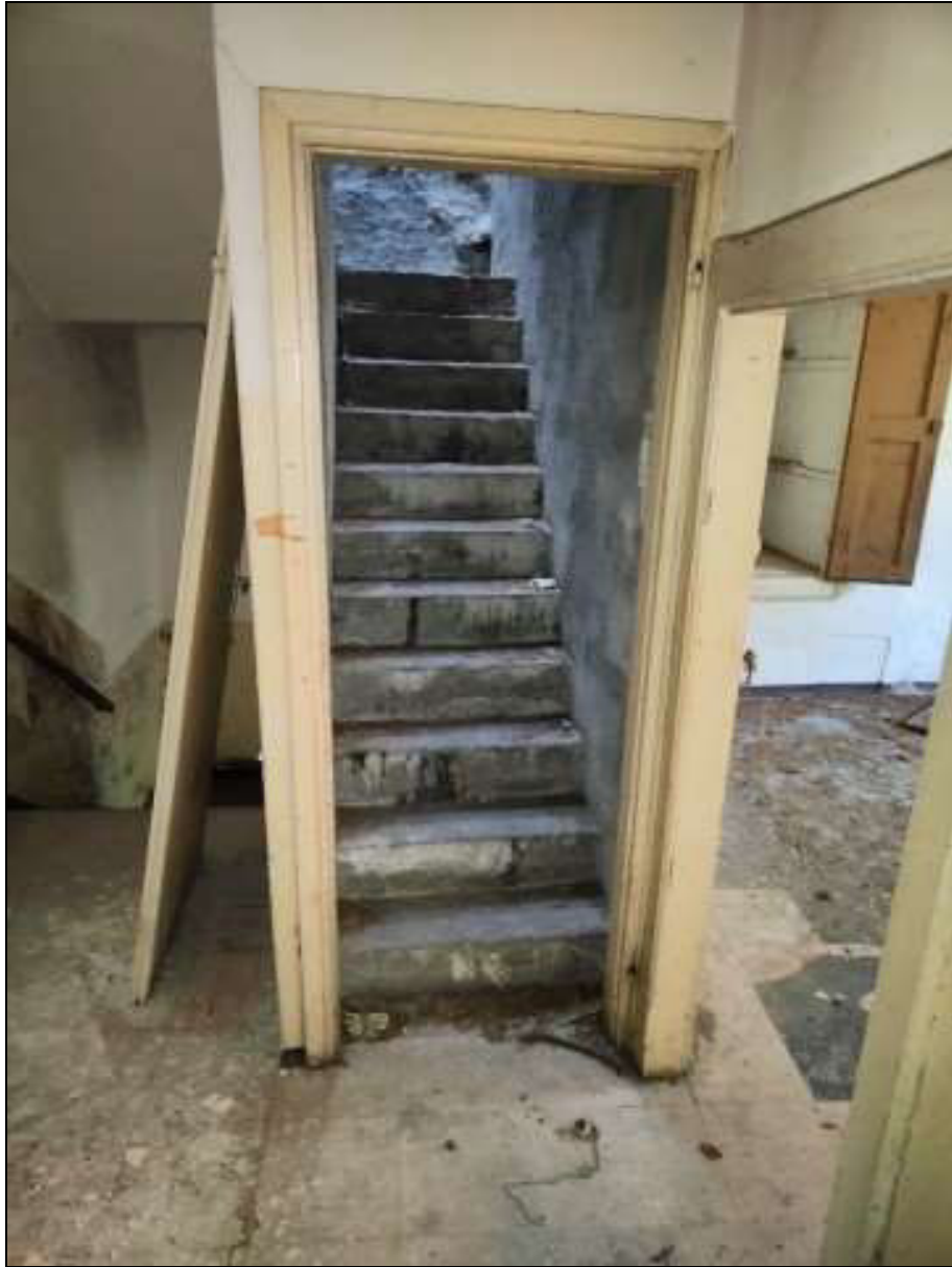
Foto n. 57 – Scala di collegamento tra il piano secondo e il piano terzo/sottotetto, del fabbricato Foglio 48 mappale 50
