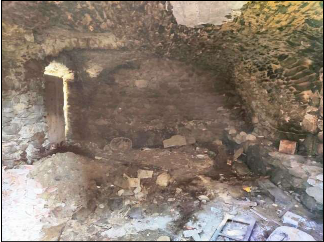
Foto n. 77 – Vista interna del ripostiglio “sud” al piano terra, identificato con il Foglio 48 mappale 48 sub. 1
