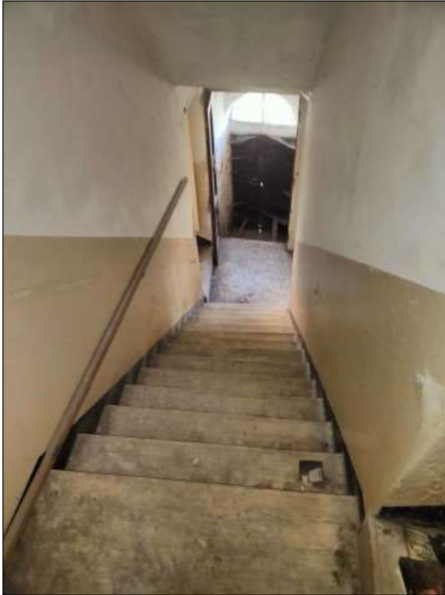
Foto n. 38 – Scala di collegamento tra il piano primo e il piano secondo (scala ovest) del fabbricato Foglio 48 mappale 50
