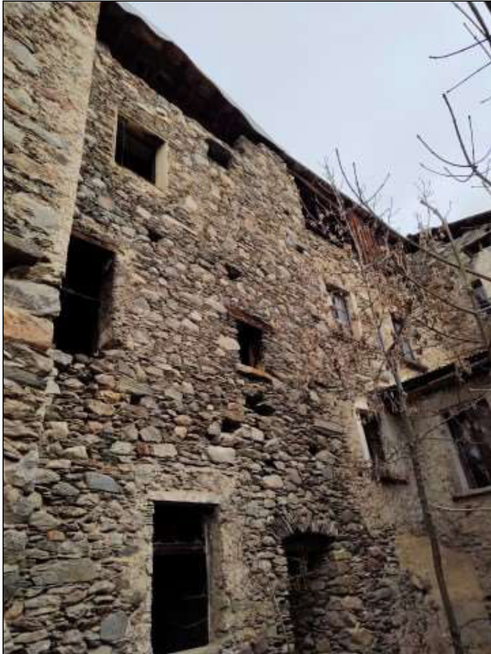
Foto n. 64 – Facciata sud (porzione est, piani alti) del fabbricato Foglio 48 mappale 47, vista da sud-ovest
