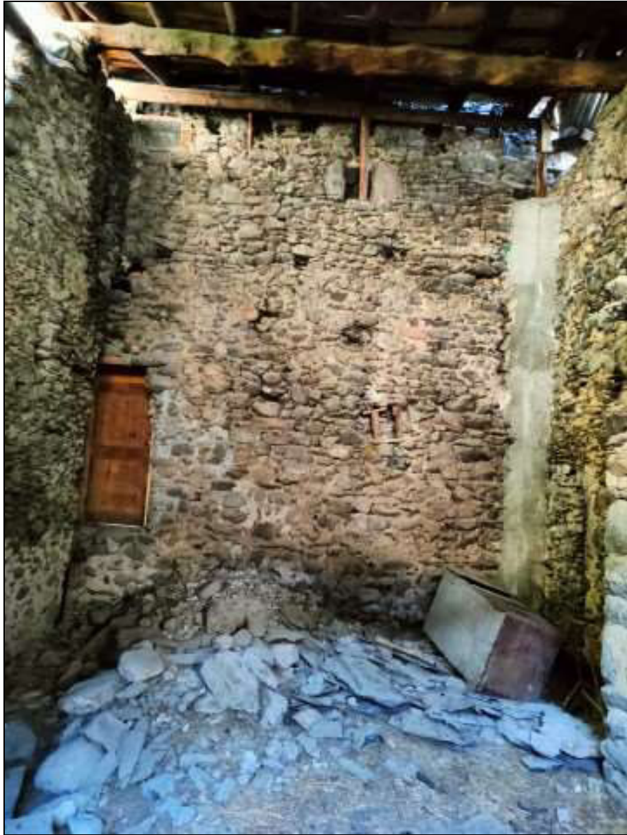
Foto n. 79 – Vista interna del ripostiglio “nord” al piano primo, identificato con il Foglio 48 mappale 48 sub. 1
