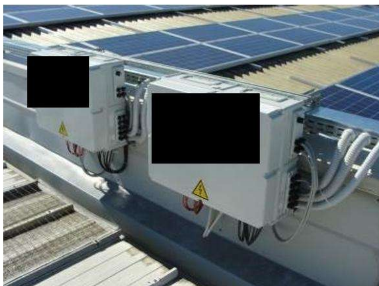
Foto 4 Stringbox su copertura fabbricato
