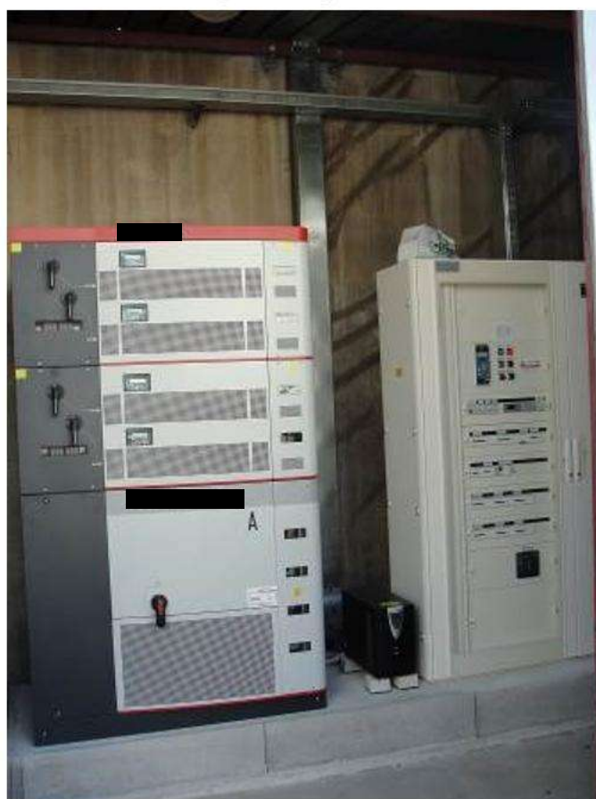
Foto 5 Inverter da 220 kW
