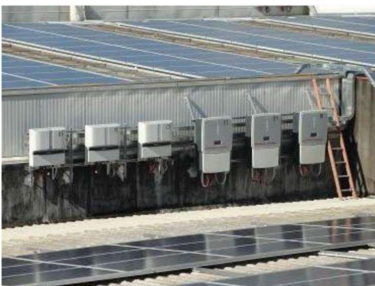
Foto 3 Inverter di stringa su copertura fabbricato
