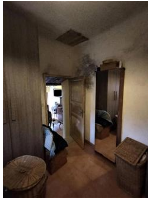
PIANO SECONDO (residenza)–vista interna del locale ex Camera, ora utilizzato come ripostiglio; sullo sfondo la porta che immette nel locale Soggiorno; sul soffitto la botola che immette nel sottotetto non abitabile e non praticabile
