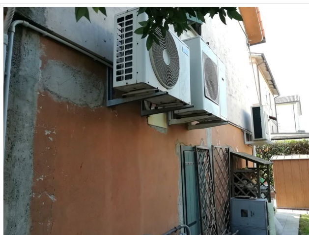
Facciata posteriore con unità esterne per climatizzazione
