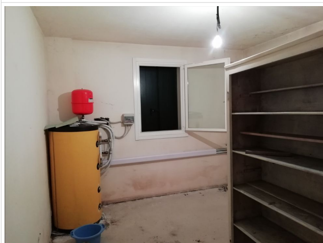
Locale Centrale termica con serb. accumulo
