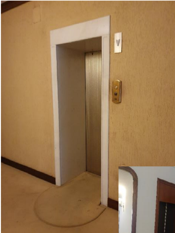
FOTO 21,22: ascensore principale e di servizio
