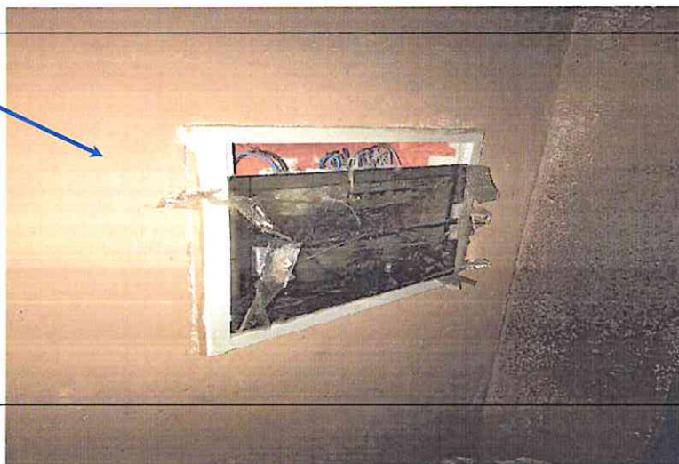
Foto 11 – Foto interna – quadro elettrico all'interno del ripostiglio adiacente alla cucina
