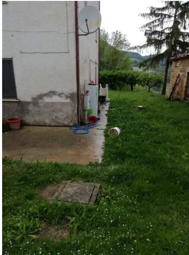
P.V.F. 23 – Pozzetto interrato con contatore acqua
