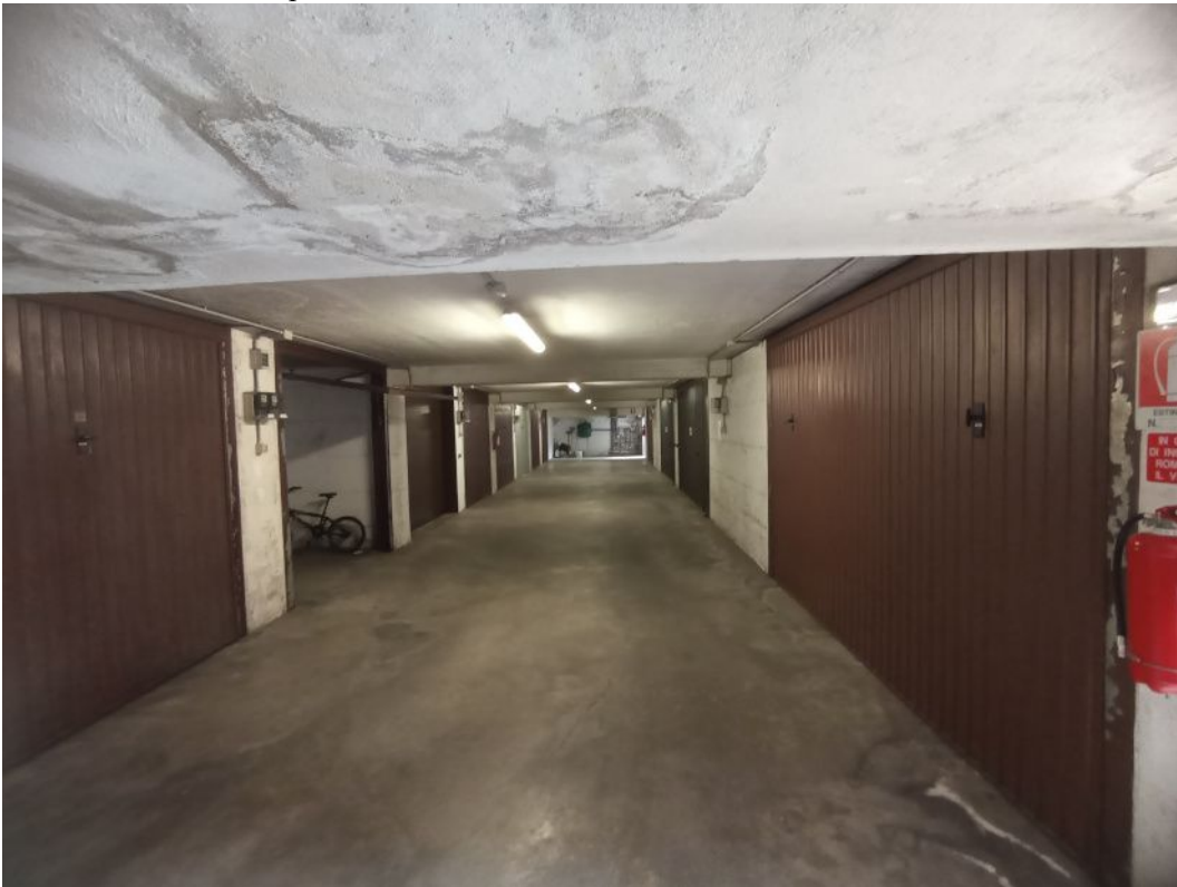
Foto 10 - Infiltrazioni dal soffitto dell'area di manovra comune, necessita il ripristino dell'impermeabilizzazione sui soprastanti cortili comuni ad onere del condominio
