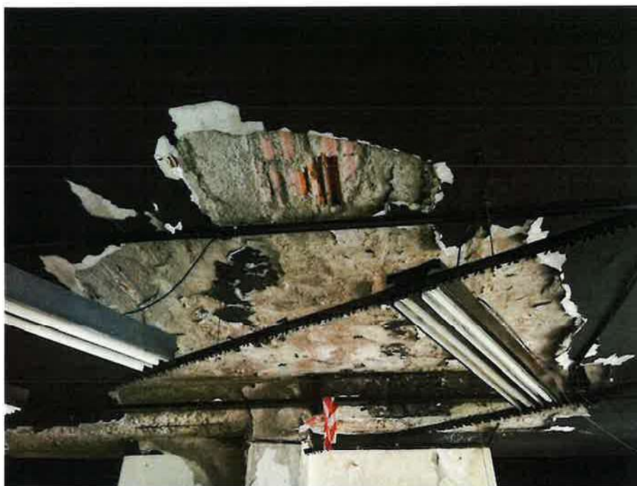
PARTICOLARE SOFFITTO DETERIORATO
