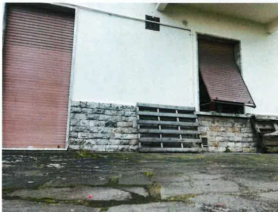
TERRAZZO PARTICOLARE PUNTO INFILTRAZIONI
