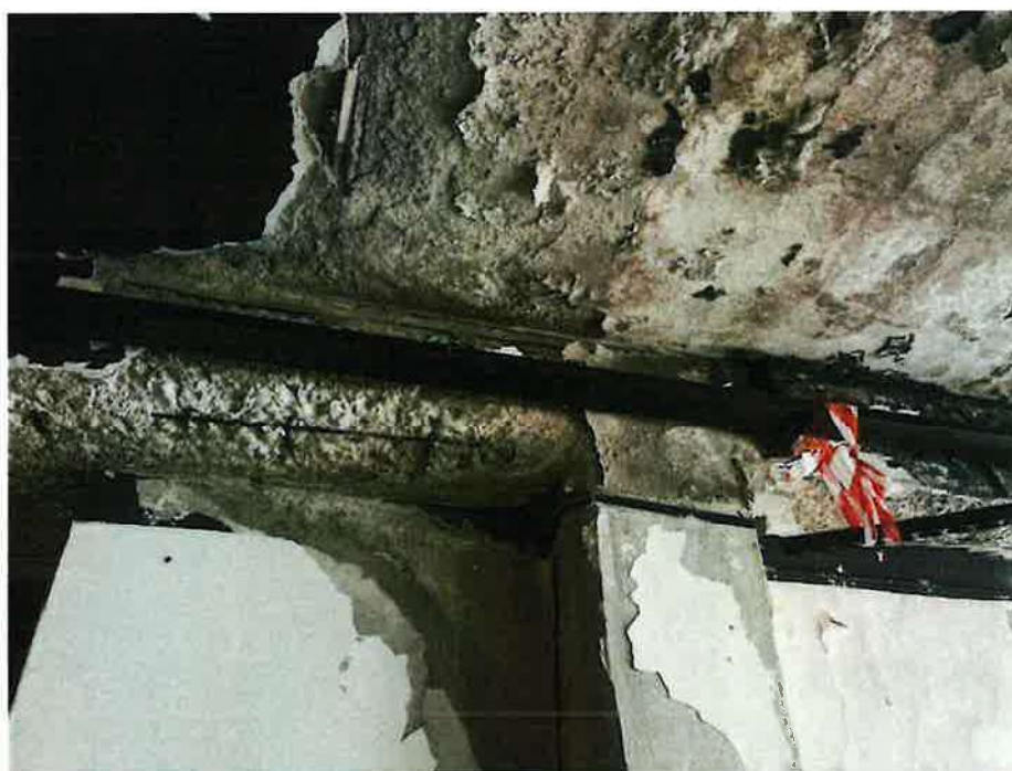
PARTICOLARE STRUTTURA DETERIORATA
