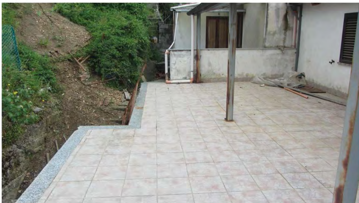
Lastrico solare con accesso incompleto
