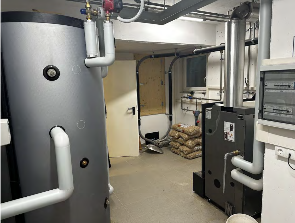
Centrale termica con silos pellet
