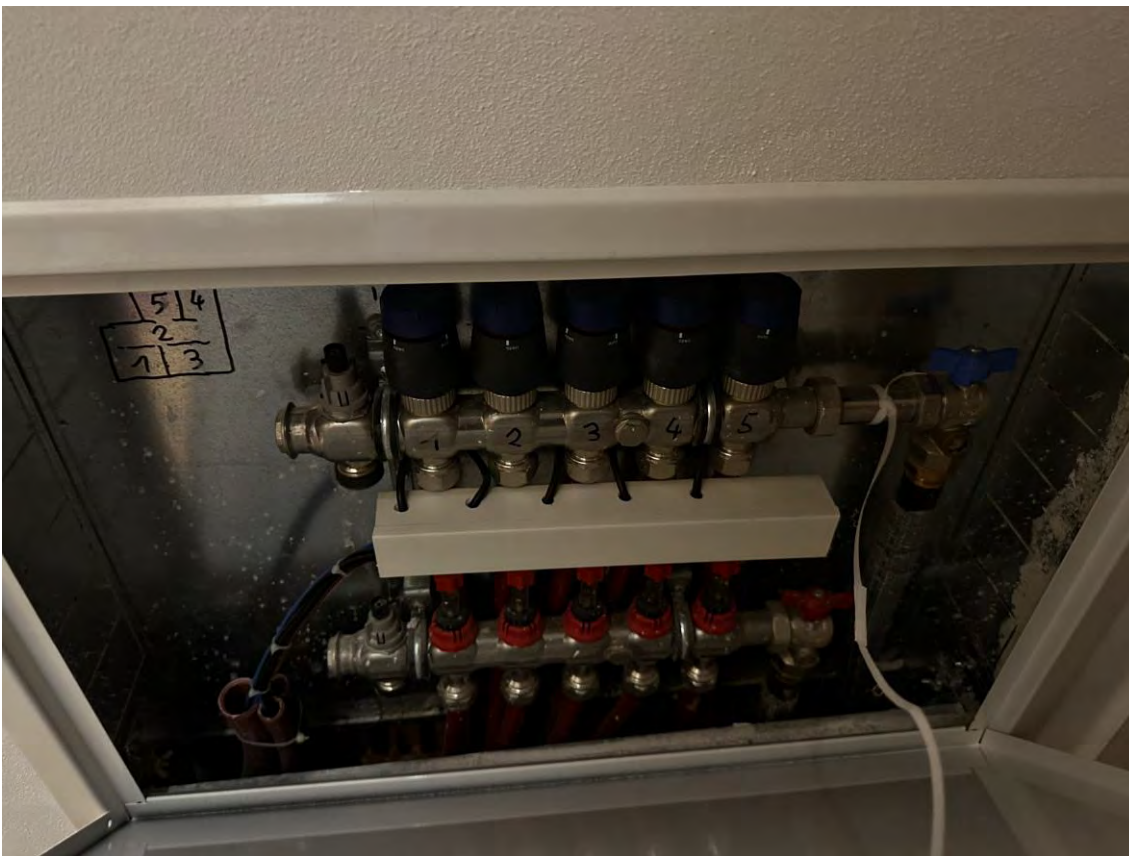
Collettore impianto radiante a pavimento
