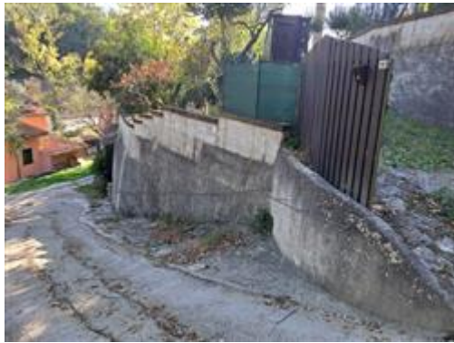
strada di accesso
