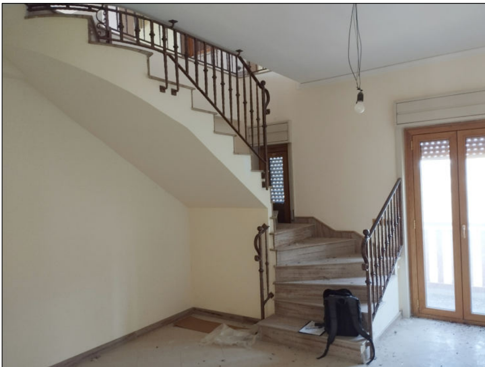
scala abusiva da demolire
