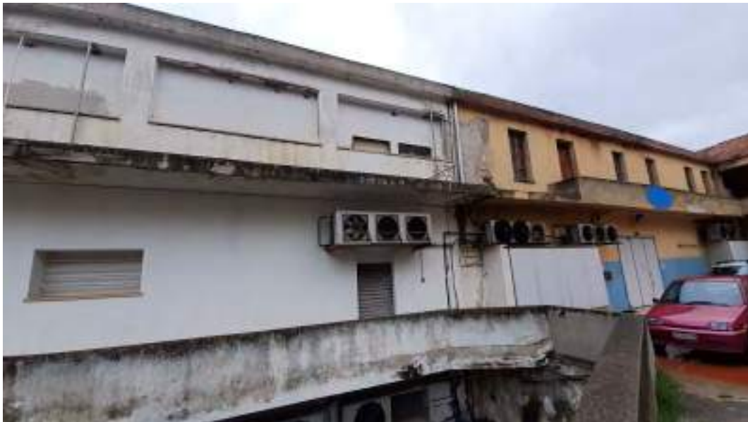
Piano terra e primo dell'opificio (a sinistra); al centro ingresso al locale spaccio
