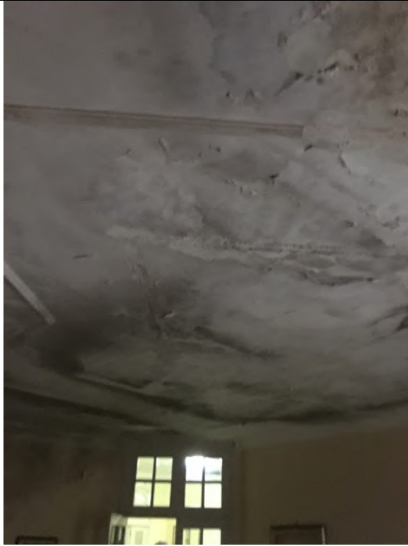
Foto n.1 – particolare soffitto vano piano primo
