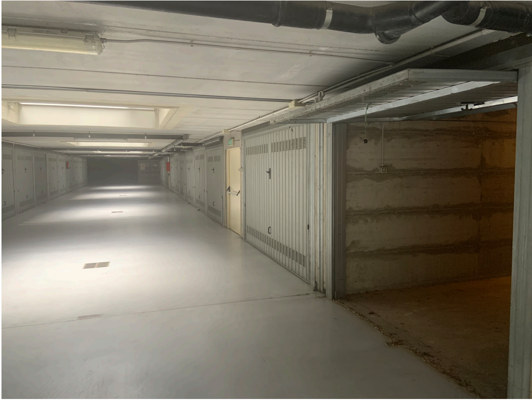
Ingresso box PS1
