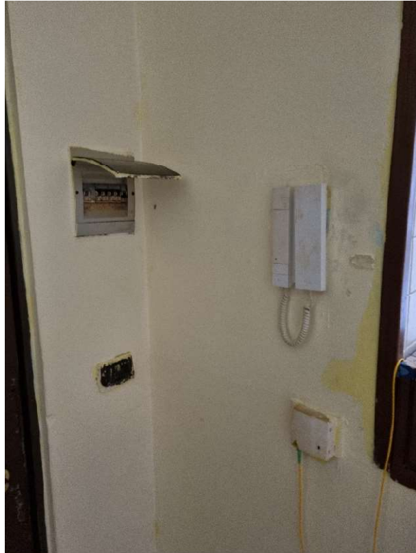
17) Quadro elettrico e citofono
