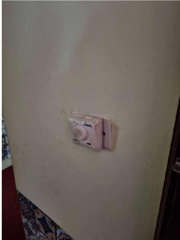
51) Termostato impianto di riscaldamento
