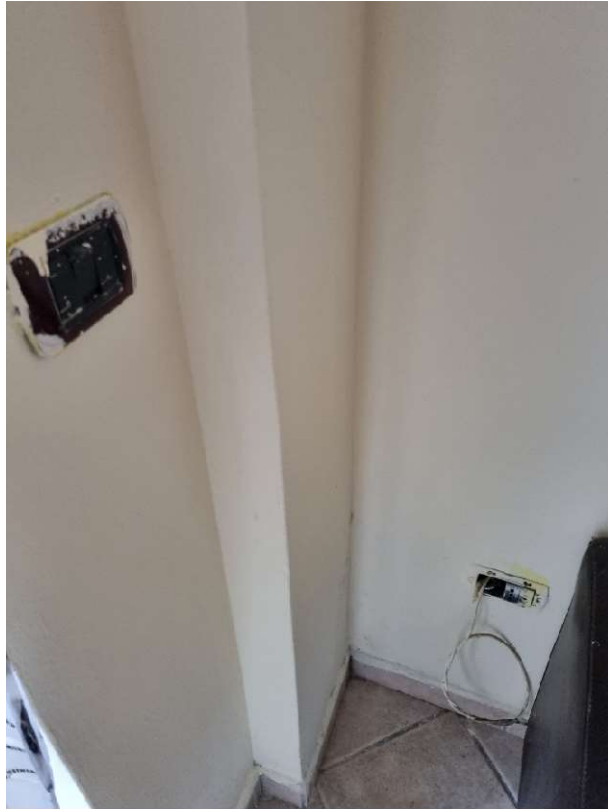
31) Comandi e prese impianto elettrico sala
