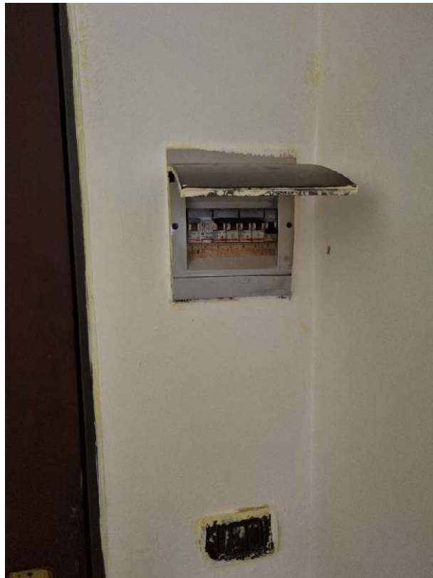
16) Quadro elettrico - differenziale
