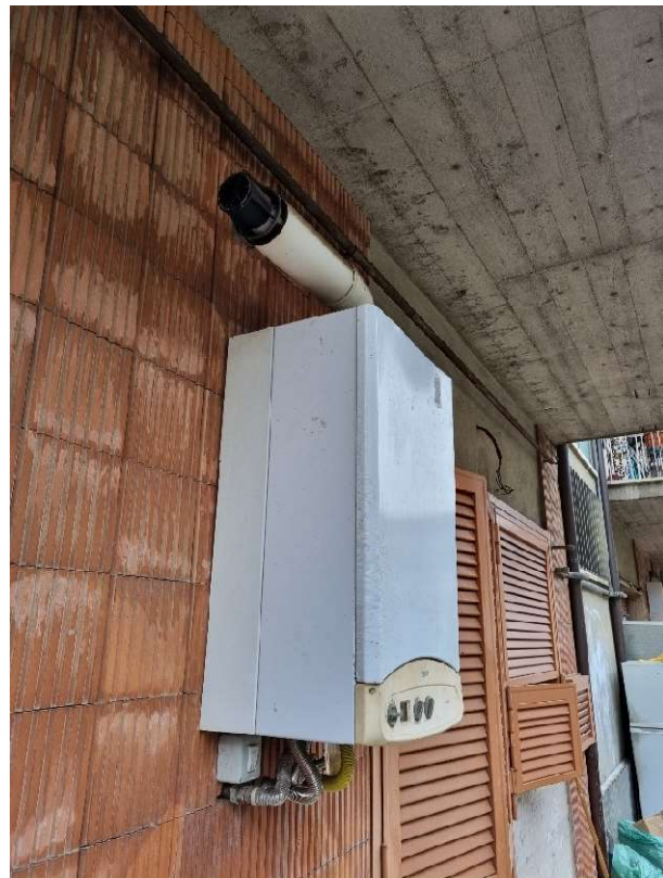
26) Terrazza cucina – Caldaia termica
