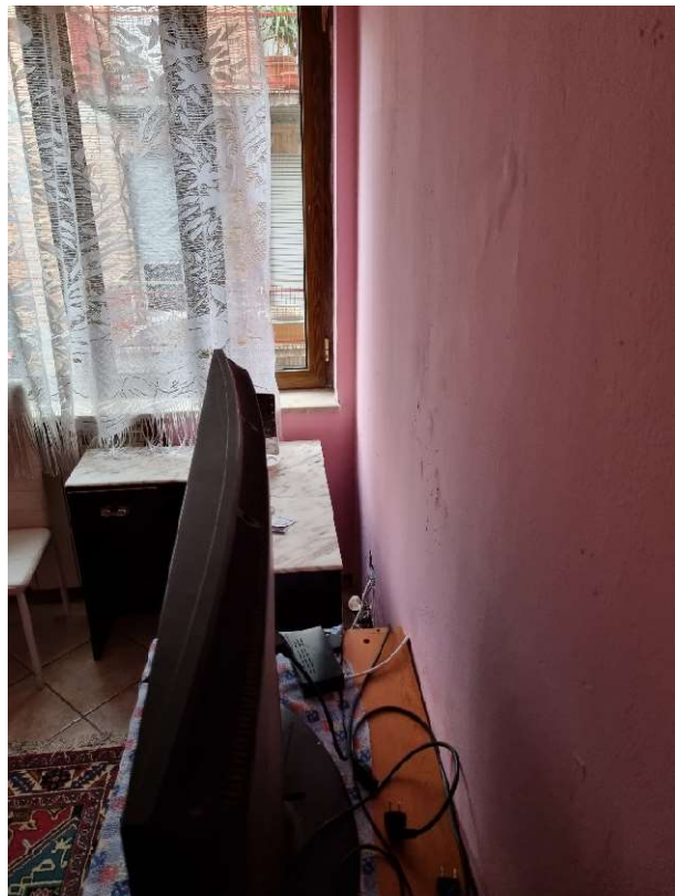
58) Impianto elettrico camera
