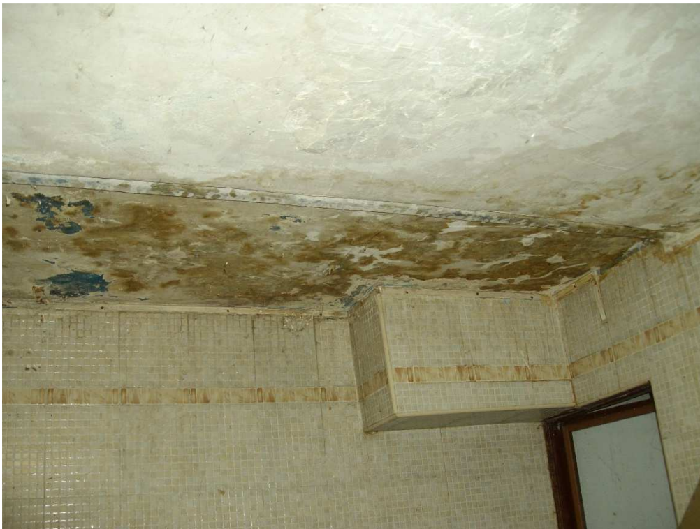
Particolare vista interna cantina: punti di infiltrazione
