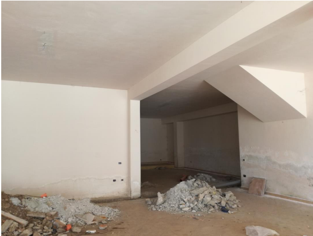
Foto 3: piano terra – al momento del sopralluogo il locale era interessato dalla presenza di uno scavo attraversato da uno scarico fognario provvisorio dei piani soprastanti.
