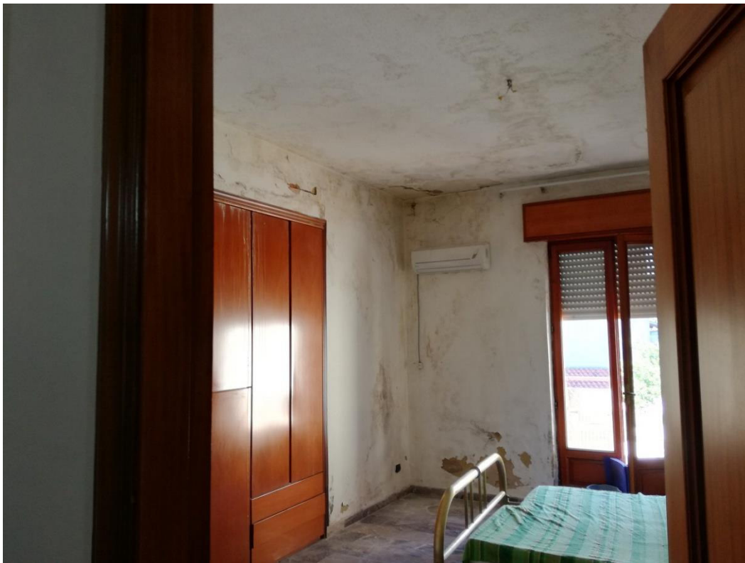
Foto 6: particella 7 sub 5 – camera con infiltrazioni di umidità dalla soprastante terrazza.
