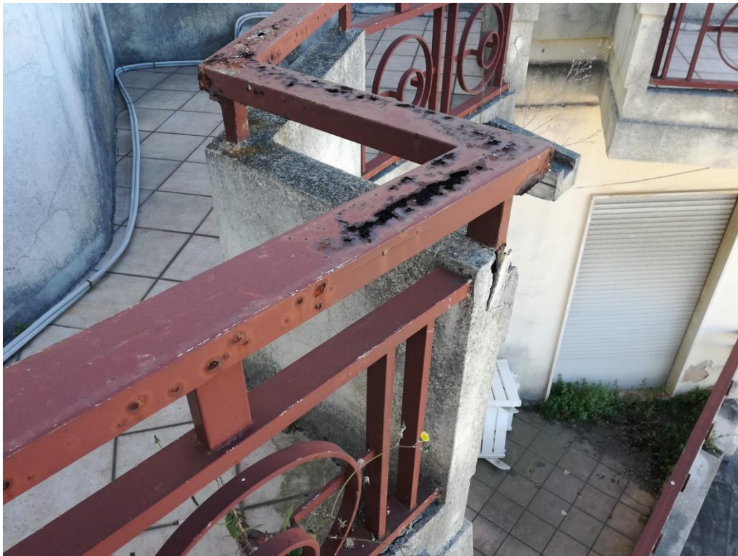
Foto 8: particella 7 sub 5 – le ringhiere dei balconi sono corrose dalla ruggine.
