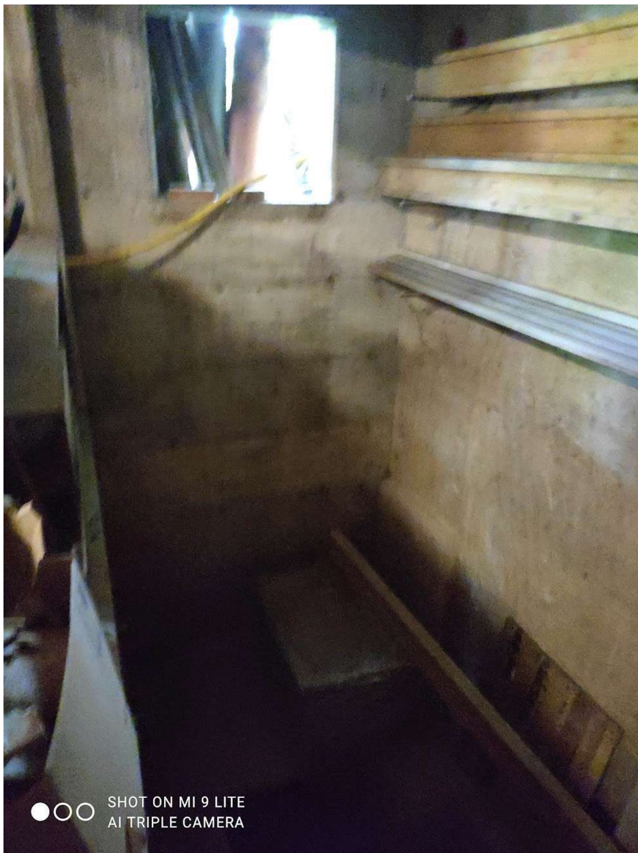
Figura 23: locale nel seminterrato non presente in progetto.
