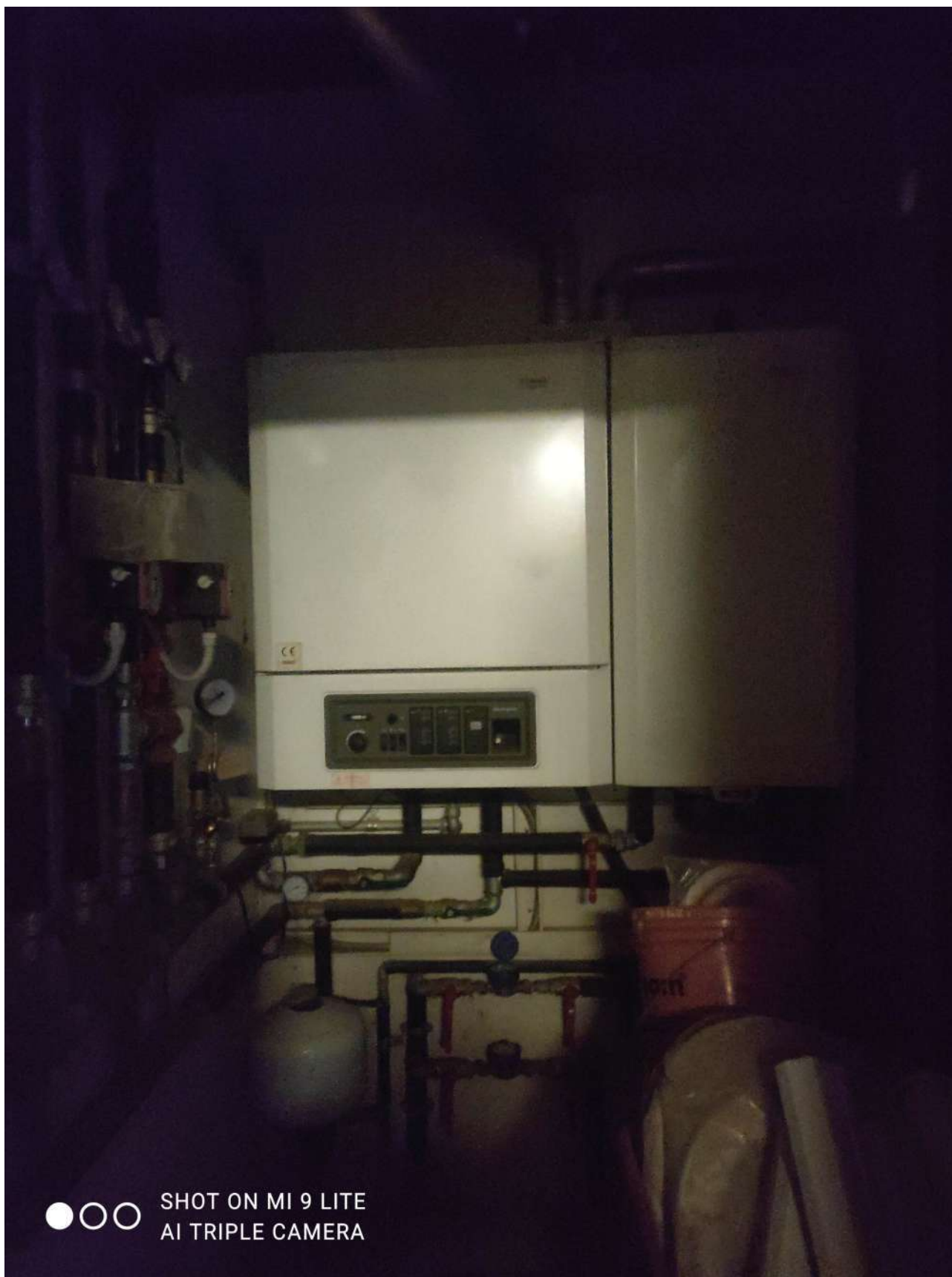
Figura 18: caldaia installata nel ripostiglio al piano seminterrato.
