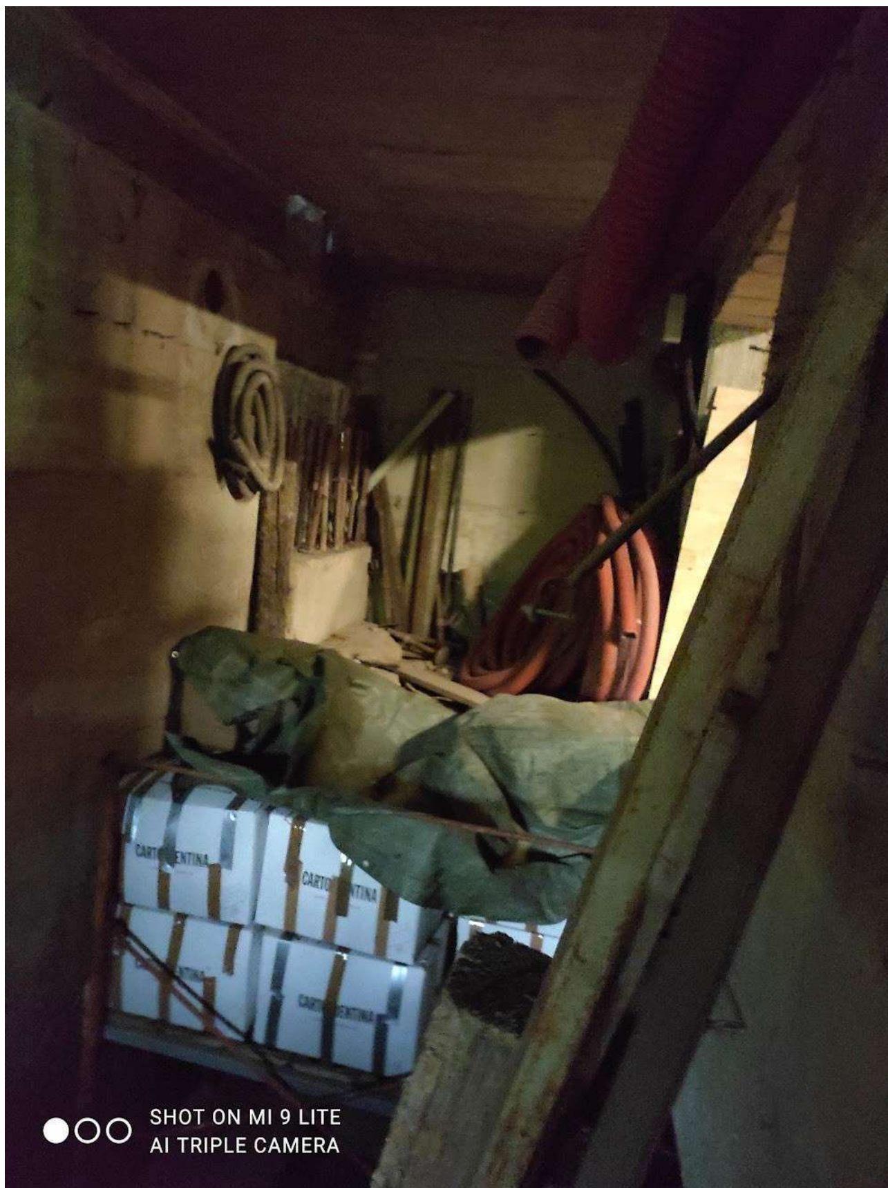
Figura 24: locale nel seminterrato non presente in progetto.
