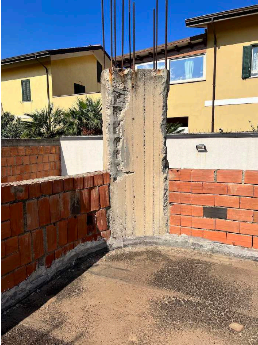
Pag. 17 – FOTO 24: Particolare del pilastro curvo esistente al piano terra, anch'esso in condizioni pessime, seppure lo strato di copriferro è in parte ancora presente. Da notare anche le condizioni pessime delle guaina orizzontale.
