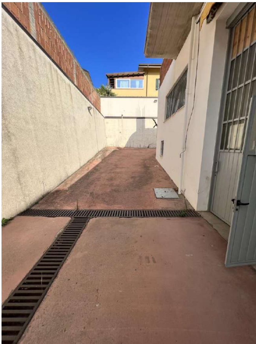
Pag. 09 – FOTO 11 : Altra vista della caditoie esistenti, nel cortile a piano cantinato, per la raccolta delle acque piovane, e vista dei muri perimetrali.
