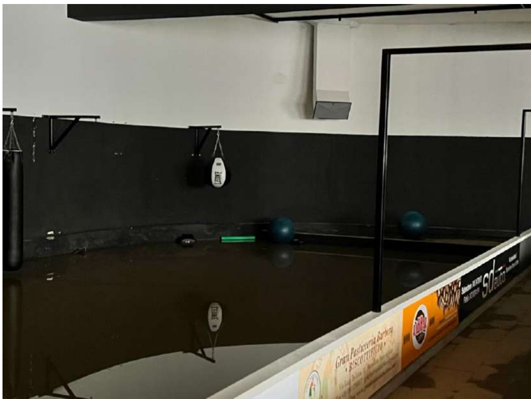
Pag. 05 – FOTO 05 e 06 : viste zoomate di una parte del piano cantinato, zona Nord-est, allagato per oltre 20 cm.
