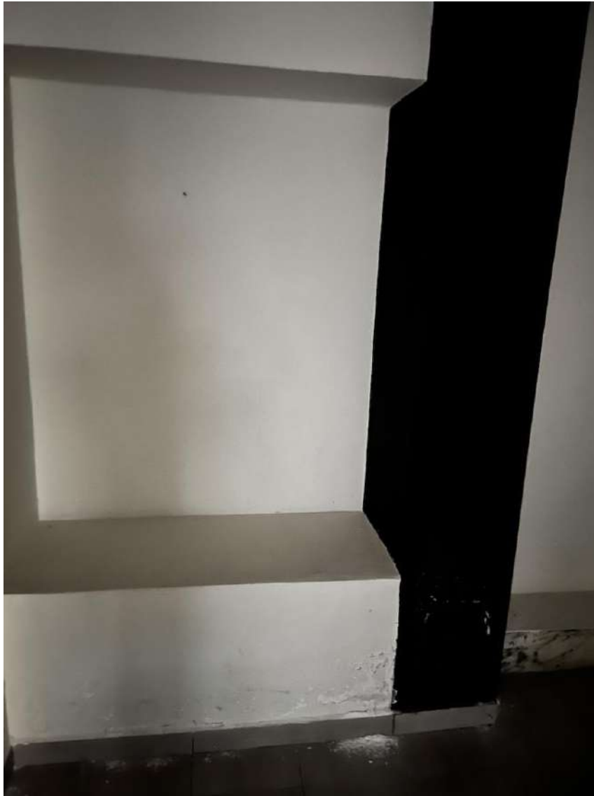
Pag. 07 – FOTO 08: Particolare dell'umidità di risalita sulla parete perimetrale, nel vano vuoto a piano cantinato.
