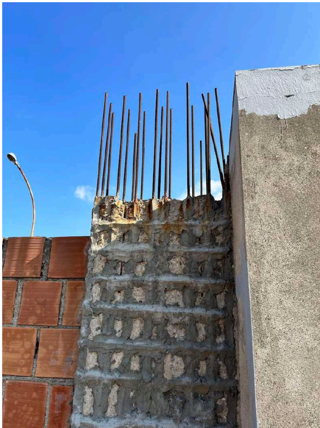
Pag. 15 – FOTO 21: Particolare di uno dei pilastri esistenti adiacenti ai muri alti, lato Nord-est, che si trova privo dello strato di copriferro ed in condizioni pessime.
