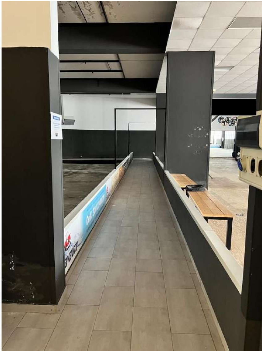
Pag. 11 – FOTO 14: Vista di una parte del piano cantinato con la zona pavimentata e i muretti bassi in cartongesso. Sono ben visibili anche: l'umidità di risalita sul muro a sinistra, e l'umidità da infiltrazione, dalla soprastante area esterna, sul soffitto.
