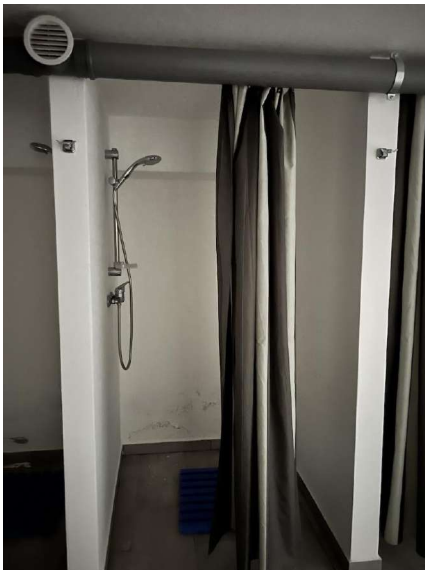
Pag. 04 – FOTO 05: Particolare della zona doccia (spogliatoio uomini) con umidità di risalita sul muro perimetrale (confinante con la rampa),
