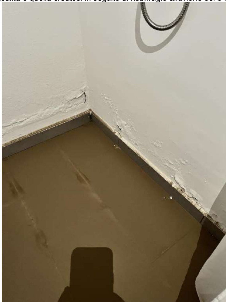
Pag. 23 – FOTO 31 e 32: Particolari di due muri vicino alle docce (zona spogliatoi) sottoposti all'umidità di risalita e quella creatosi in seguito al nubifragio-alluvione del 3 dicembre 2022.
