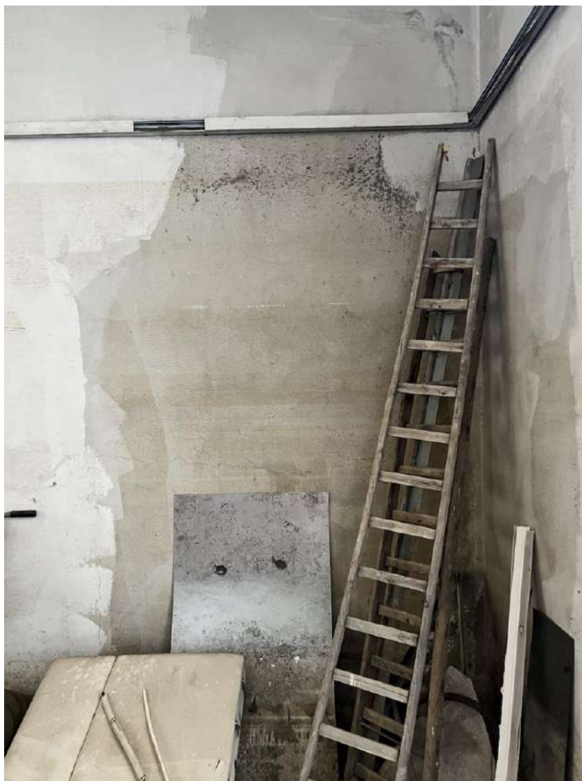
Pag. 17 – FOTO 24: VANO ADIACENTE A PIANO CANTINATO Particolare del muro lato esterno (interrato) di questo vano.
