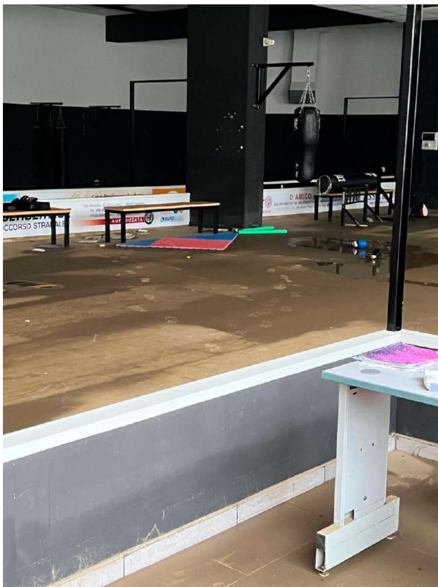
Pag. 03 - FOTO 03: Vista di una porzione del parte centrale del piano cantinato (parquet), non praticabile, con vaste chiazze di acqua e patina di fango.
