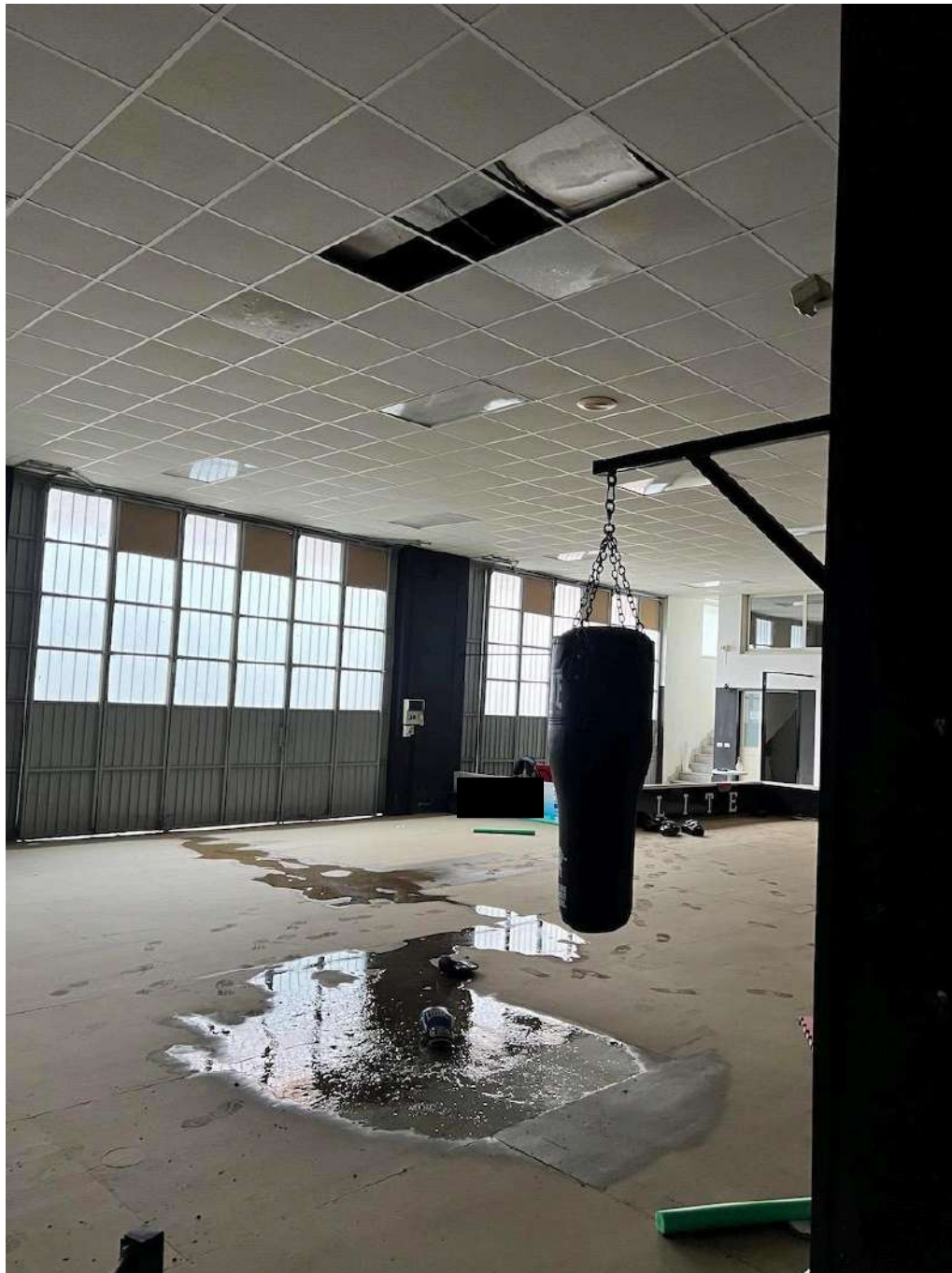
Pag. 20 – FOTO 27: Vista del vano centrale del piano cantinato, con le chiazze ancora visibili dell'acque penetrata dal cortile e di quella infiltrata dalla soprastante area esterna attraverso il controsoffitto, in seguito al nubifragio-alluvione del 3 dicembre 2022, quest'ultima che sta determinando anche il distacco di alcune pannelli dal controsoffitto.
