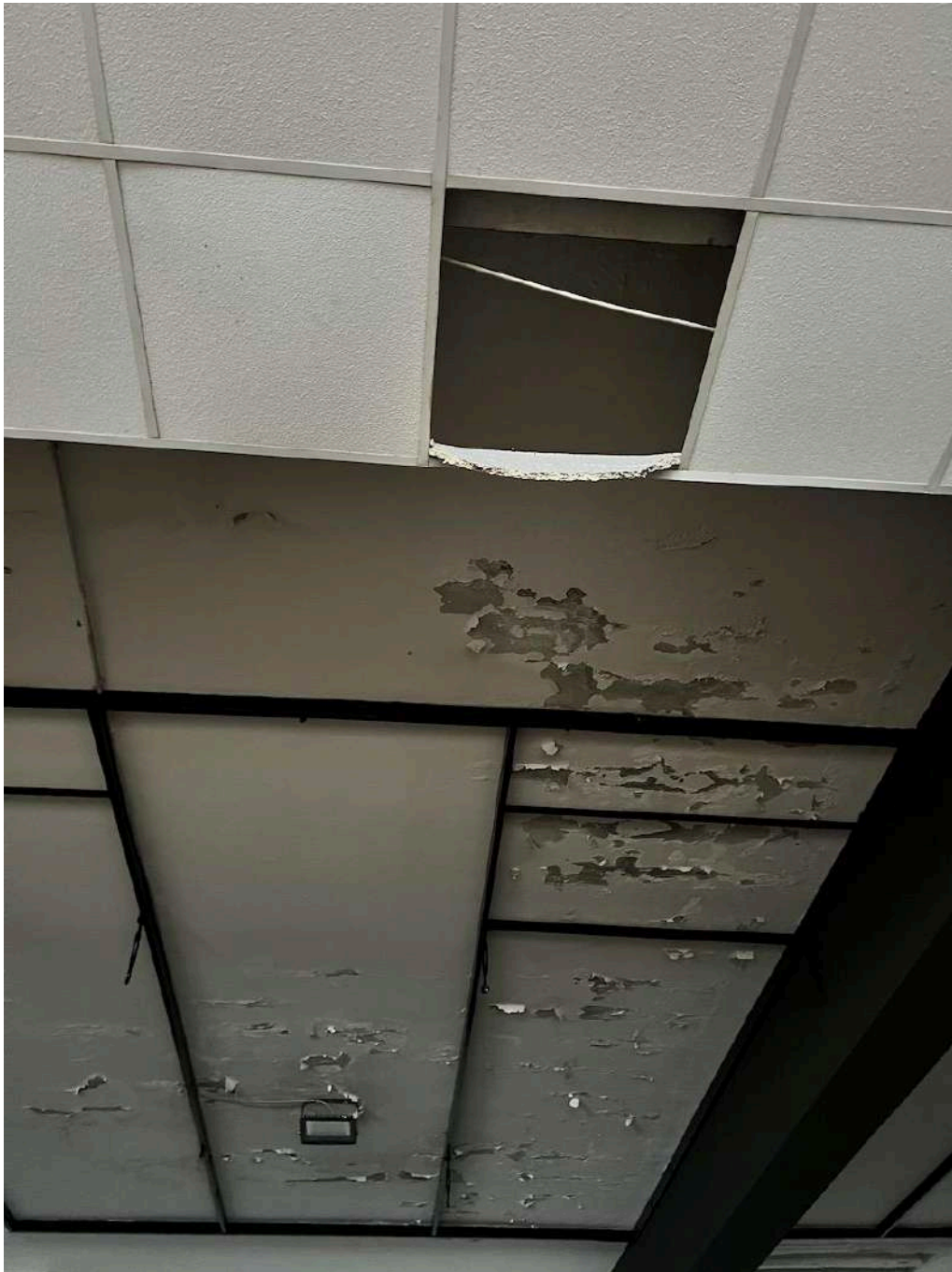
Pag. 25 – FOTO 34: Altra vista del solaio di copertura nella zona Nord-Est, e di una parte del controsoffitto della zona centrale, del piano cantinato; notasi il distacco di un pannelli dal telaio (come avvenuto in altri punti), in seguito al nubifragio-alluvione del 3 dicembre 2022.
