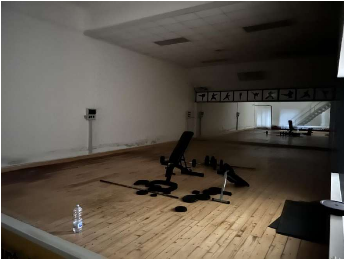
Pag. 10 – FOTO 13: Vista dell'intero vano vuoto (presumibilmente utilizzato in tempi recenti per alcune attività sportive della Palestra), e dell'umidità sulla parte inferiore del muro perimetrale e del controsoffitto.
