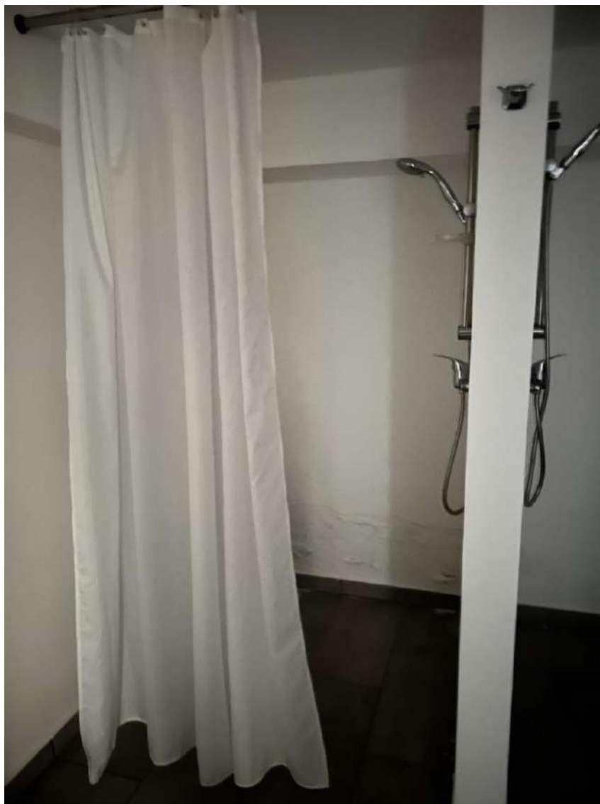
Pag. 06 – FOTO 07 : particolare di una delle docce, negli spogliatoi donne, con umidità di risalita sul muro perimetrale (confinante con la rampa esterna).
