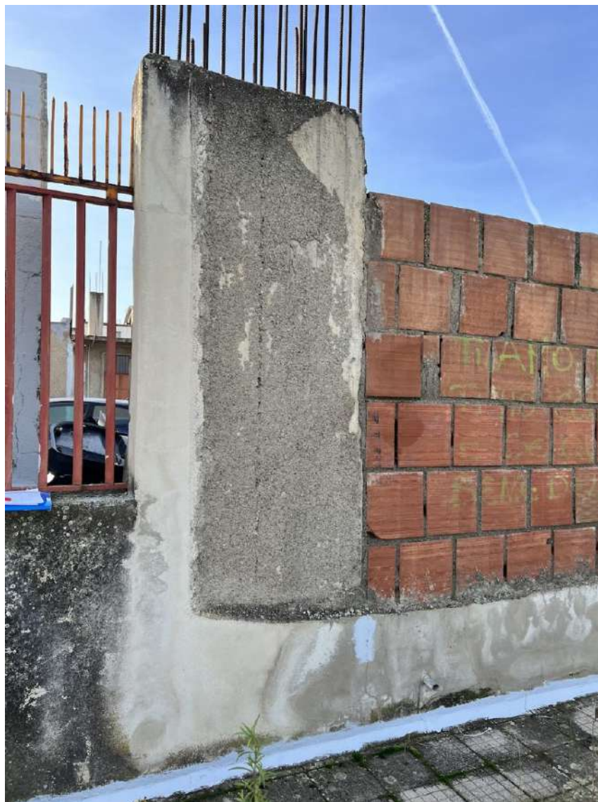
Pag. 08 – FOTO 09 : Vista del Pilastro che segna la fine del muretto basso e l'inizio del muro alto perimetrale dell'area esterna dell'immobile.
