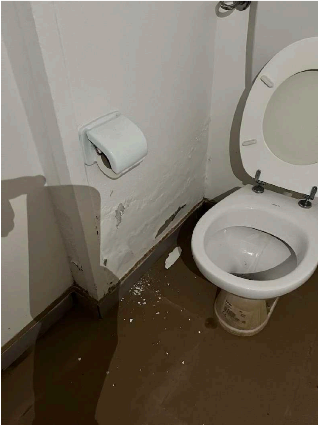
Pag. 22 – FOTO 30: Particolare di un muro vicino ad un wc, negli spogliatori Uomini, sottoposto all'umidità di risalita ed al fango creatosi in seguito al nubifragio-alluvione del 3 dicembre 2022.
