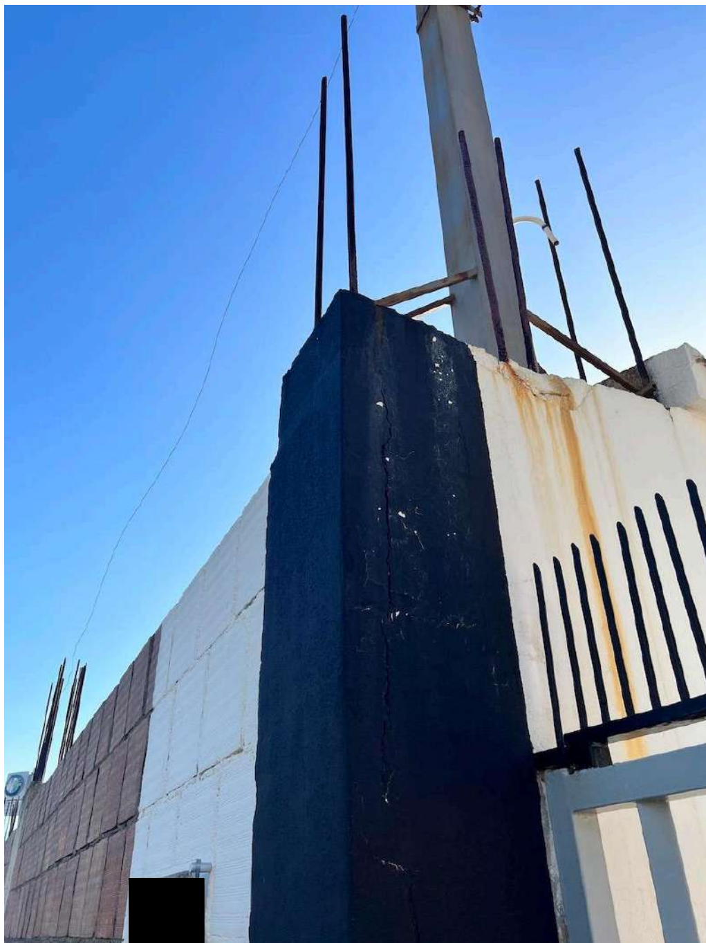
Pag. 09 – FOTO 10 : Vista del pilastro lato monte che delimita il cancello di ingresso alla rampa, dal n.c. 51 di via Cav. Luigi Stilo.
