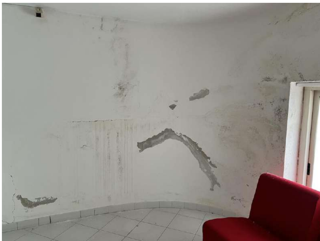
FOTO 05 (del 16-12-22): Particolare dell'umidità sulla parete curva del vano ingresso, in corrispondente alla rampa esterna.
