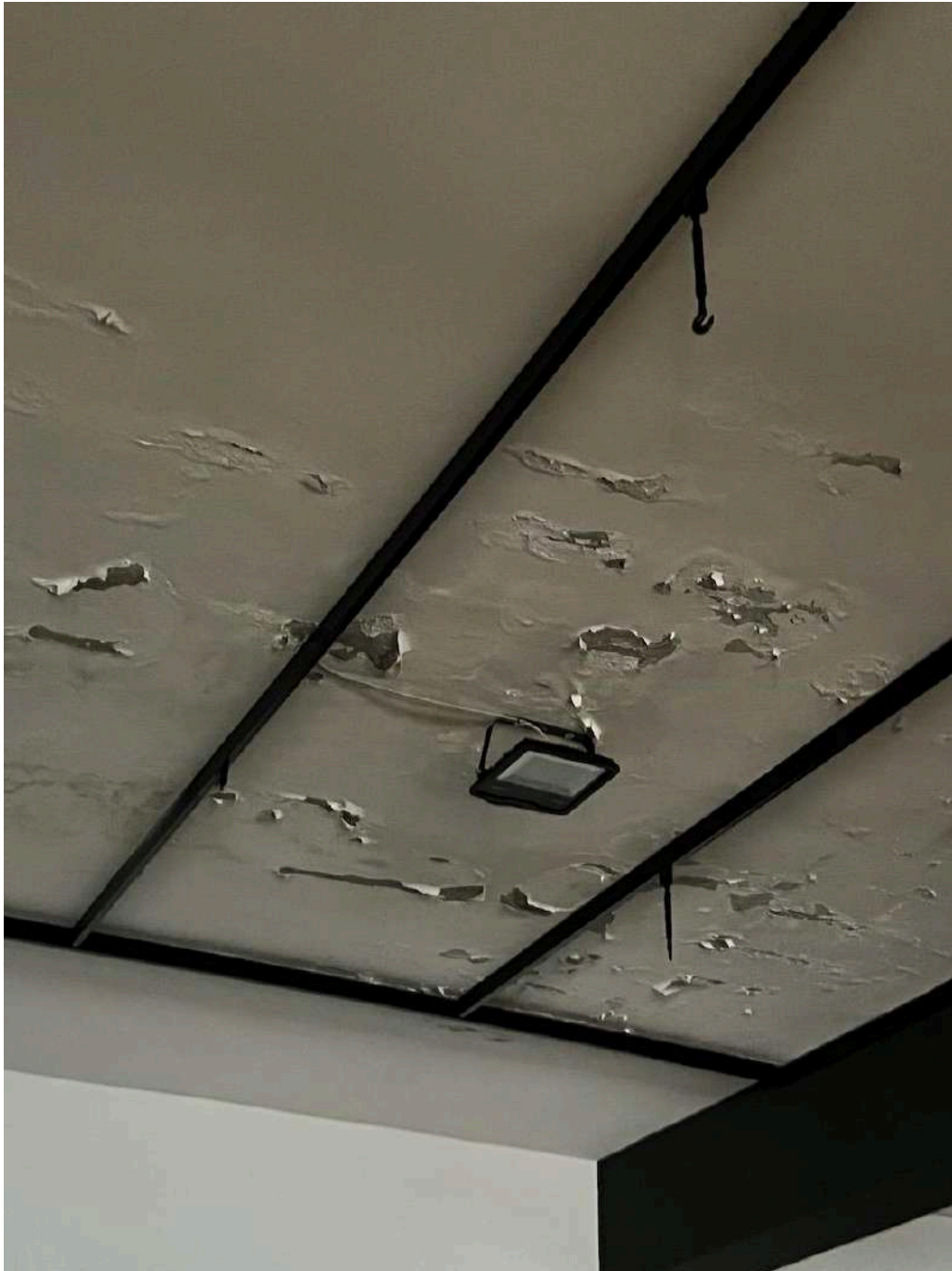
Pag. 24 – FOTO 33: vista delle condizioni del solaio di copertura nella zona Nord- Est del piano cantinato (privo di controsoffitto) con le vaste aree di umidità da infiltrazione, dalla soprastante area esterna (pesantemente condizionata dal recente nubifragio-alluvione del 3 dicembre 2022).
