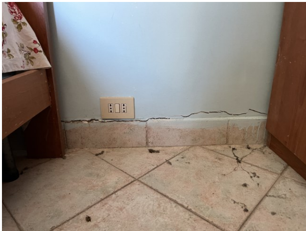
Vista fessurazioni camera da letto
