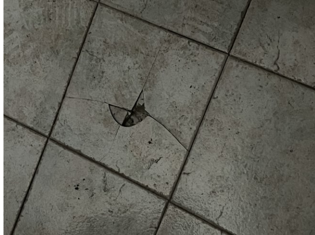
vista pavimentazione danneggiata
