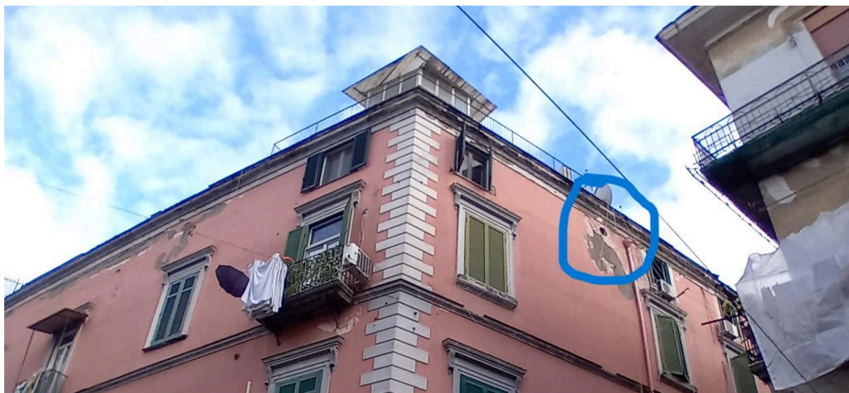
FOTO 31 – Dettaglio di infiltrazioni d’acqua e di umidità diffusa sulla muratura del fabbricato prospiciente Discesa Sanità
