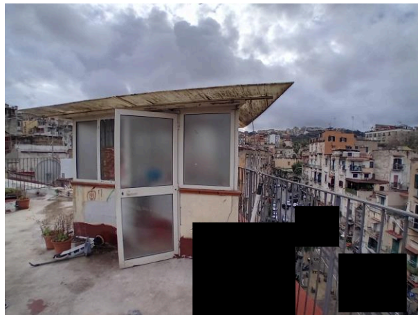
FOTO 35-37 – Lo smonto della scala e l’accesso al lastrico solare: in evidenza la presenza della veranda di copertura del vano scala
