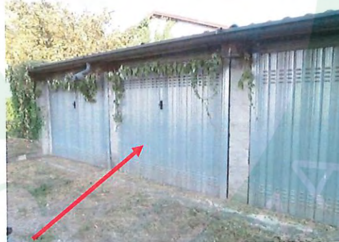
Locale ad uso autorimessa inserito nel Corpo B autorimesse
