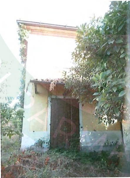
Porta d'ingresso: realizzata con scuri in legno e serratura di sicurezza, che da accesso diretto all'appartamento dall'area cortilizia pertinenziale privata
