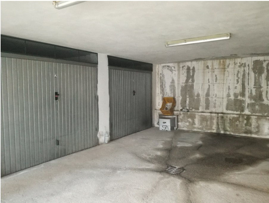
Foto 22: Ingresso box sub 18
