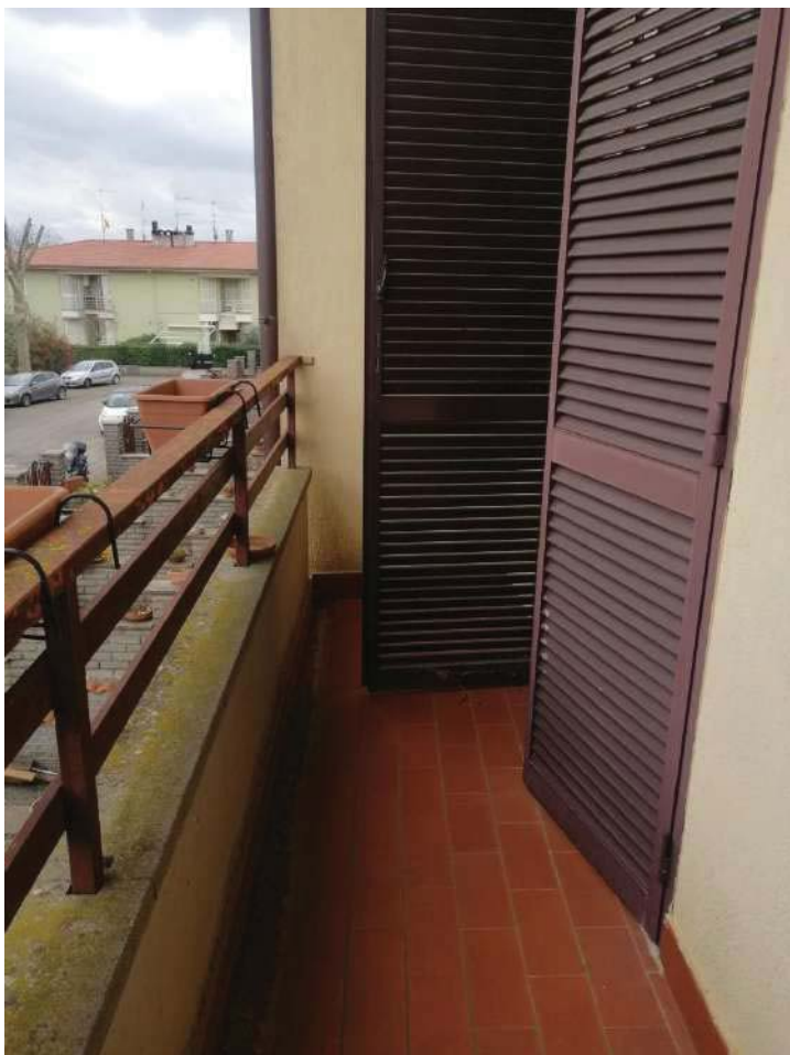
Foto 23 – Balcone Piano Primo
