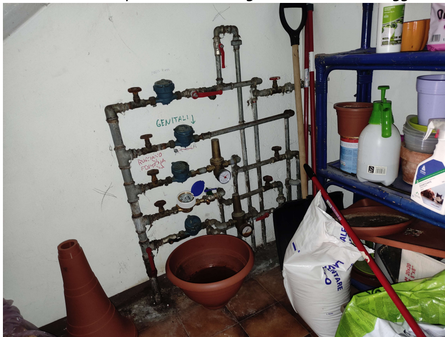
FOTO 4 - Vista contatori acqua sotto scala ingresso da Via 24 Maggio 37
