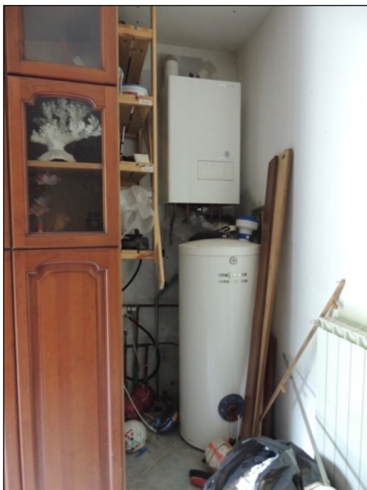
Foto 26 – il soggiorno A, la calderina (disattivata) e il serbatoio del sistema di riscaldamento dell'immobile
