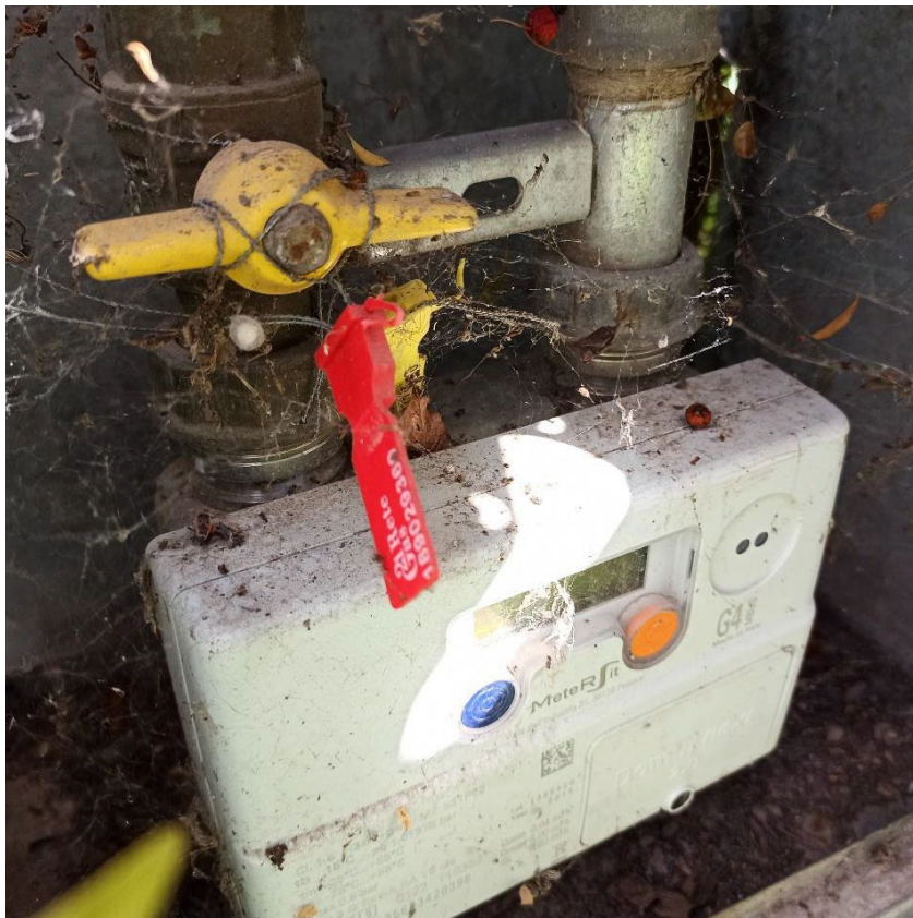
Foto n.06 - fornitura GAS - ubicata all'interno del Bene n. 2 - area urbana foglio 15 part. 1294 sub 1 - (foto da sopralluogo del 30/04/2024)
