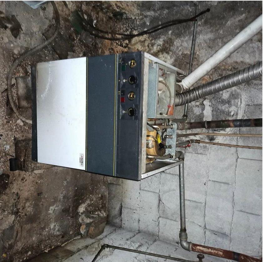
Foto n.07 - Caldaia ubicata al piano seminterrato dell' immobile negozio
