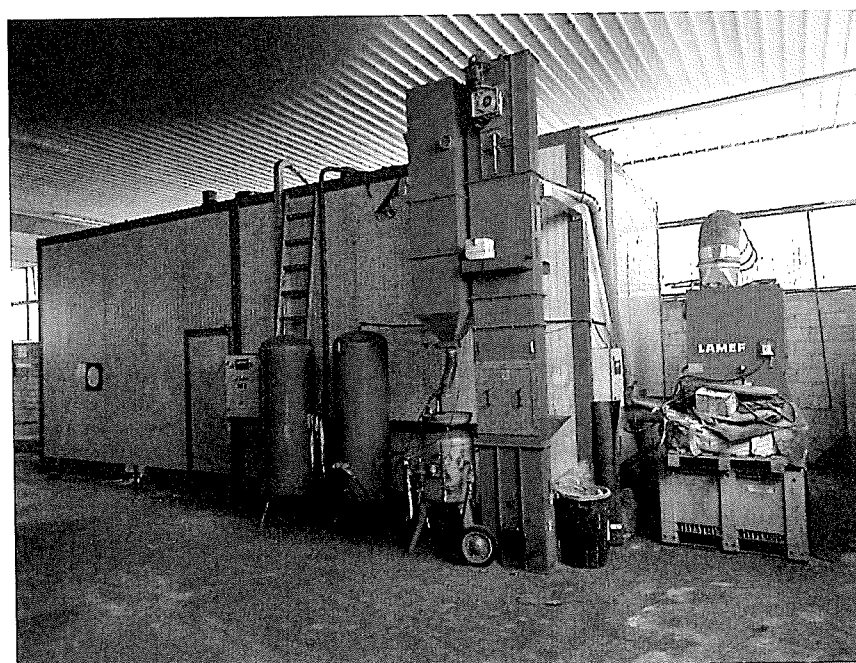
Foto 14: Cabina di Sabbatura LAMEF
