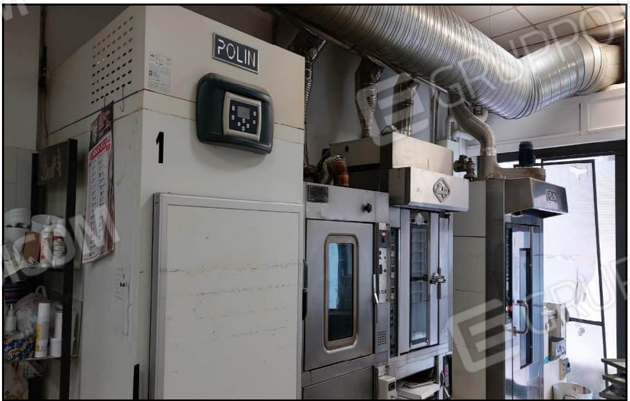
Foto 4. Vista frigoriferi e impiantistica del locale
