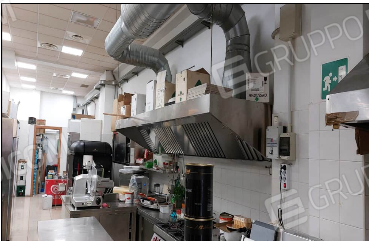
Foto 6. Vista piano cottura e cappe aspiranti
