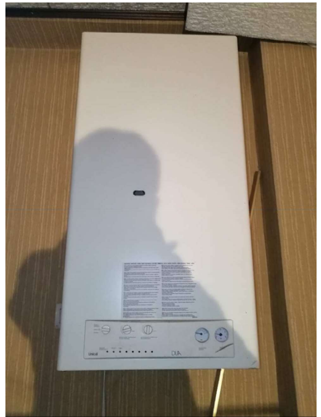
Foto 15 – Caldaia a metano a P.2°
