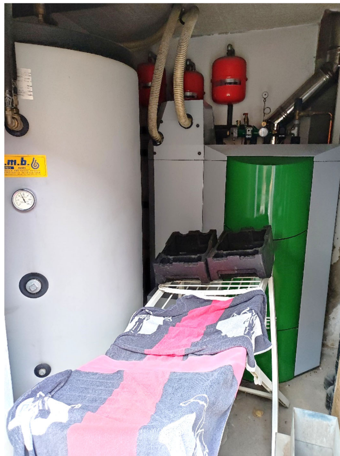
24. Centrale termica, piano terra
