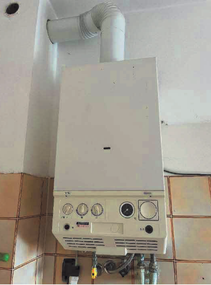
FOTO 7 – CUCINOTTO OVE CALDAIA
