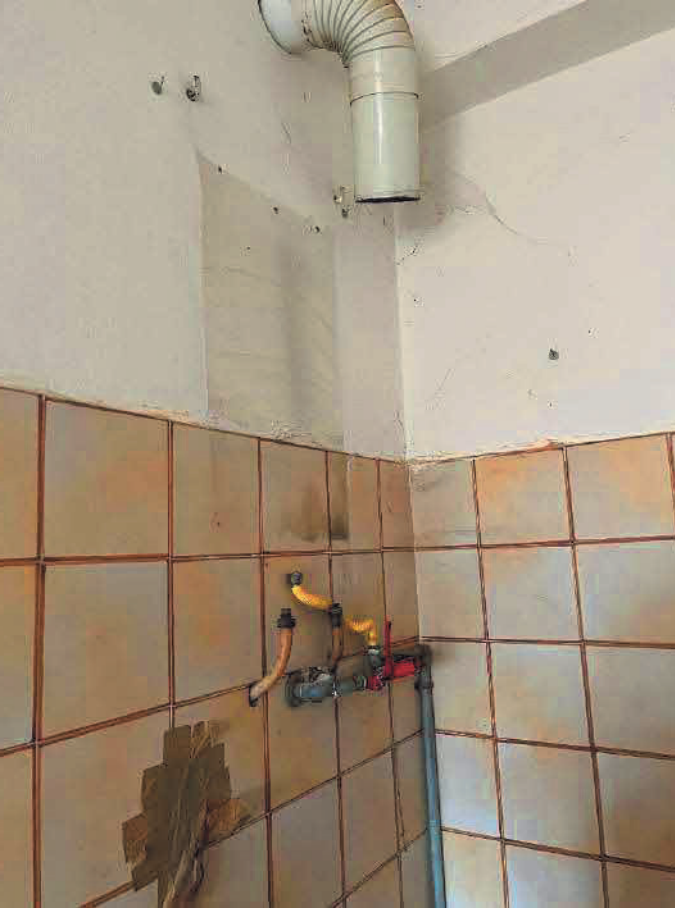
FOTO 7 – CUCINOTTO OVE CALDAIA
