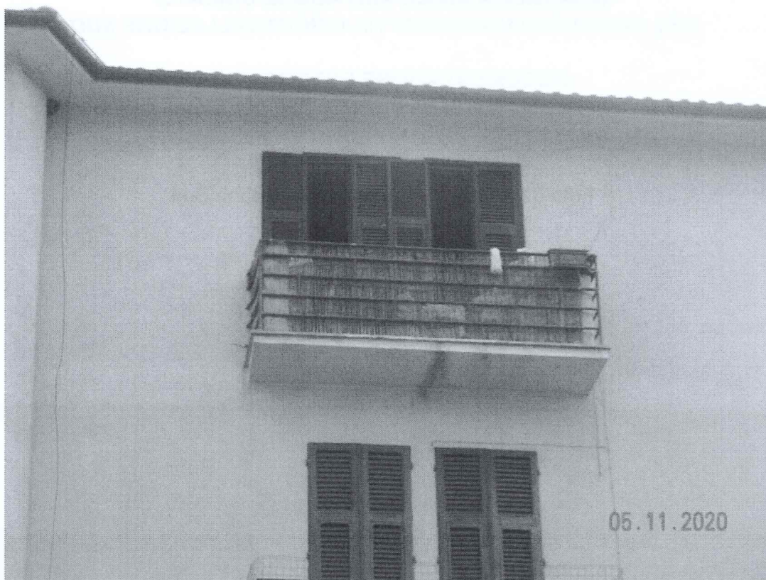
Foto 02 - Terrazzo su Via Circonvallazione Sud
