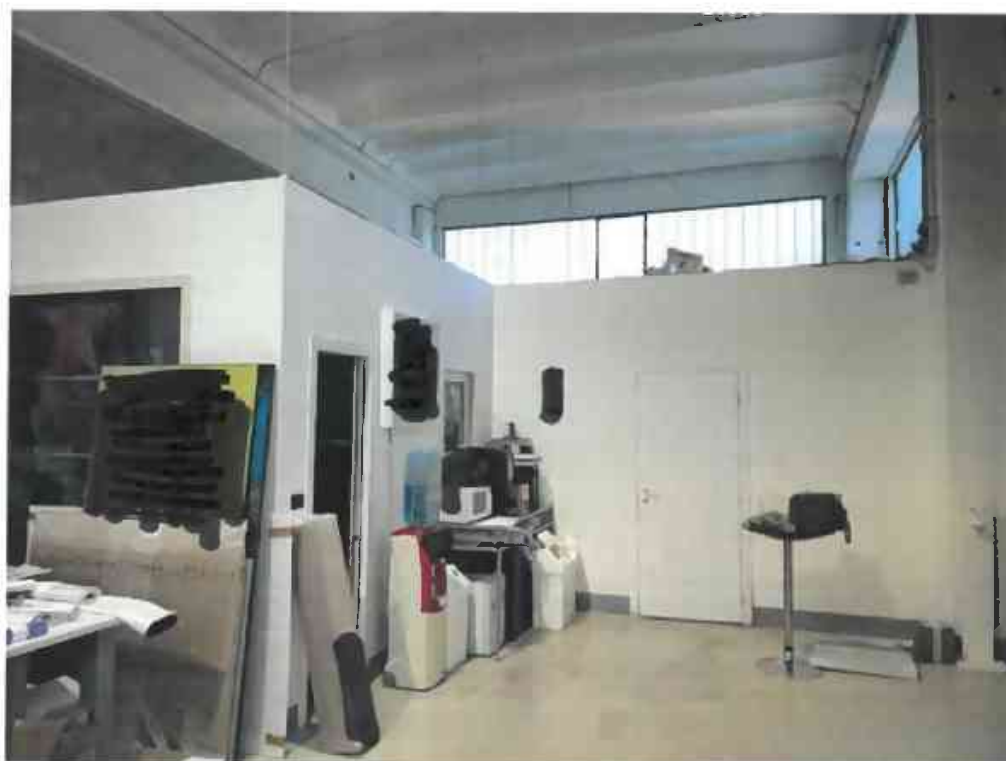
Foto 12 – Opificio e locale interno realizzato senza autorizzazioni
