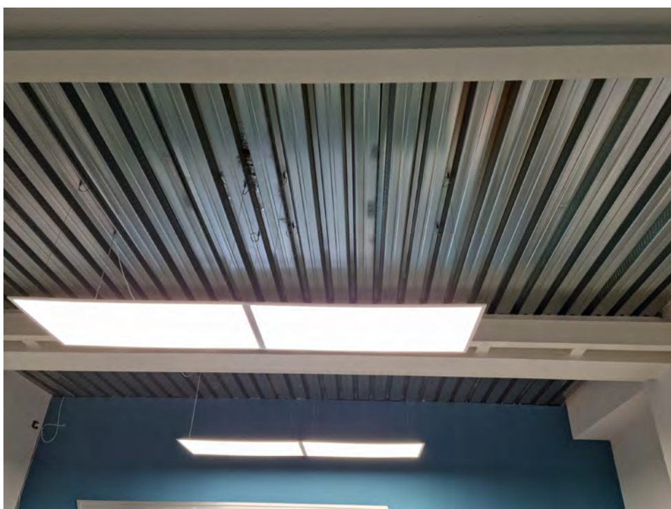
Foto 27 – Particolare illuminazione LOTTO 5
