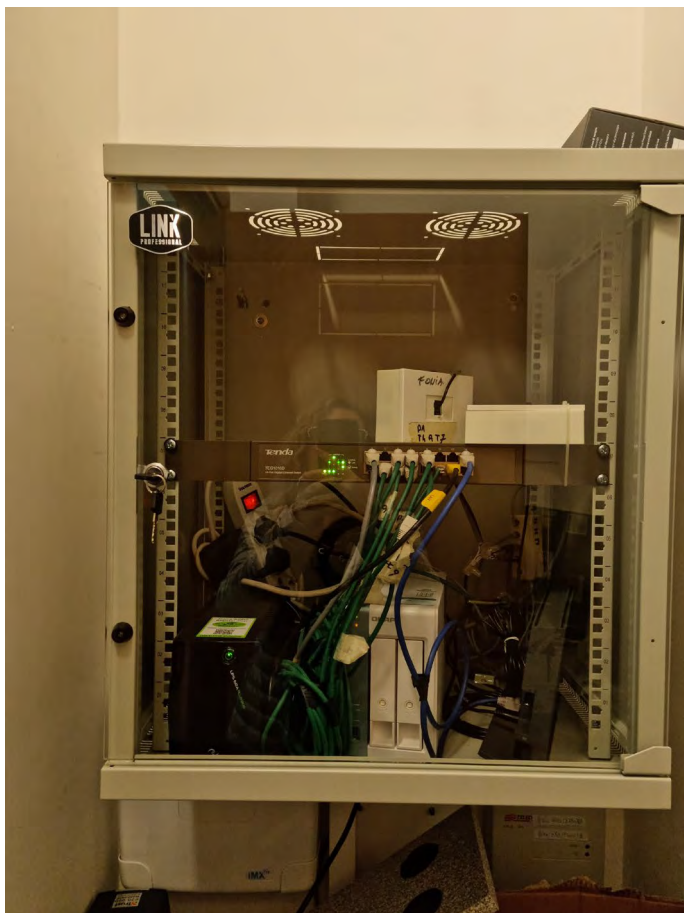
Foto 25 – Particolare centralina elettrica LOTTO 5
