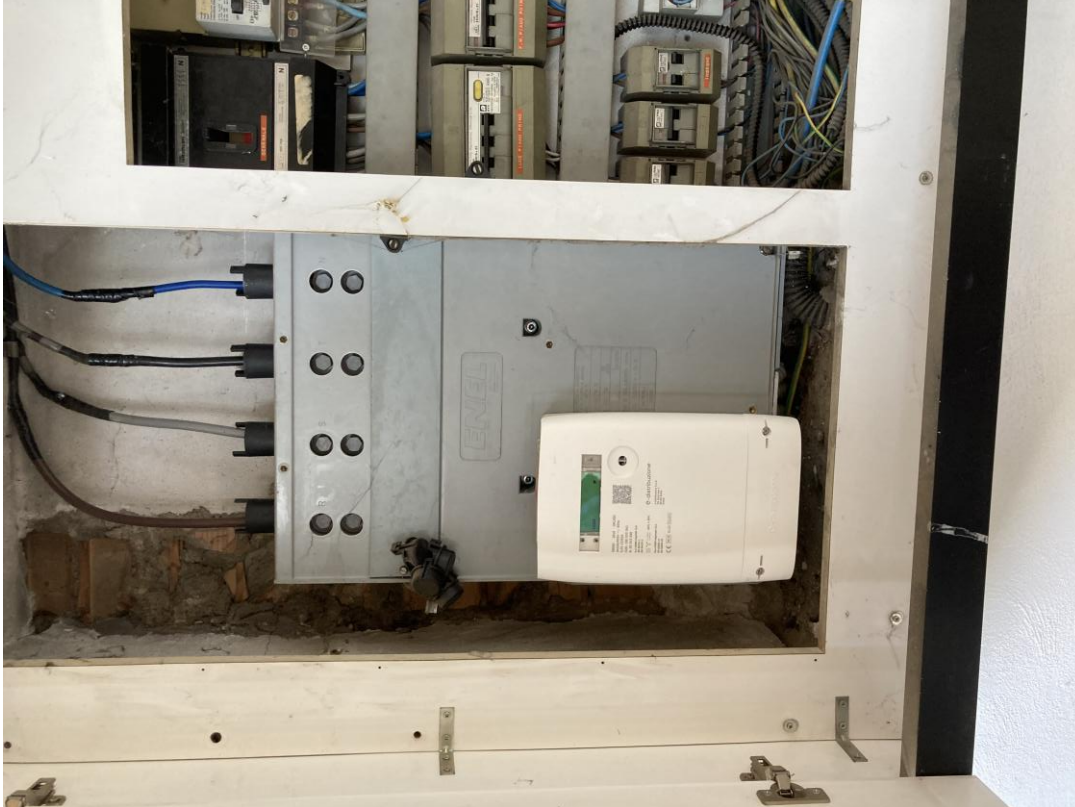
FOTO 7 –CONTATORE GENERALE E QUADRO ELETTRICO (LOTTO B).
